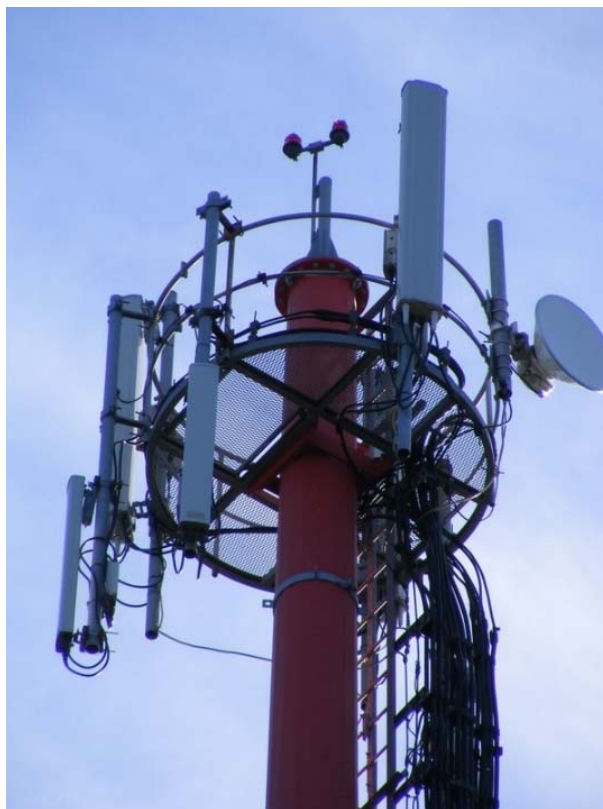
Figura 1 – Troço superior Troço superior de uma Torre de Telecomunicações (plataforma, painéis, links)
