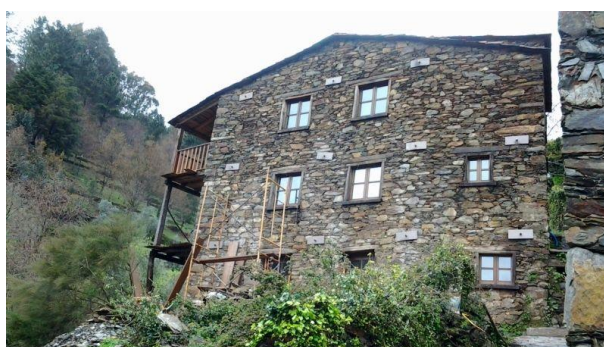
Figura 2.37 - Fachada de um edifício com chapas de ancoragem de tirantes (Planirest Construções Lda)
