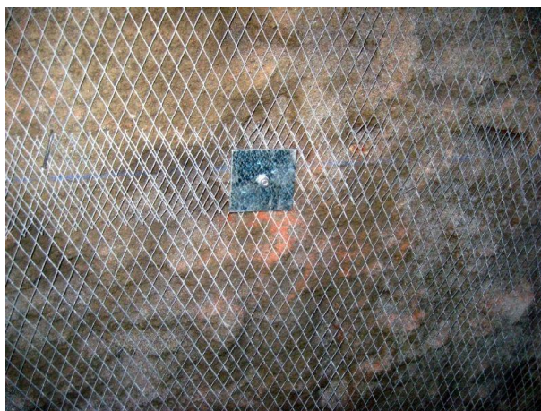
Figura 2.29 - Pormenor de conectores (Planirest Construções Lda)
