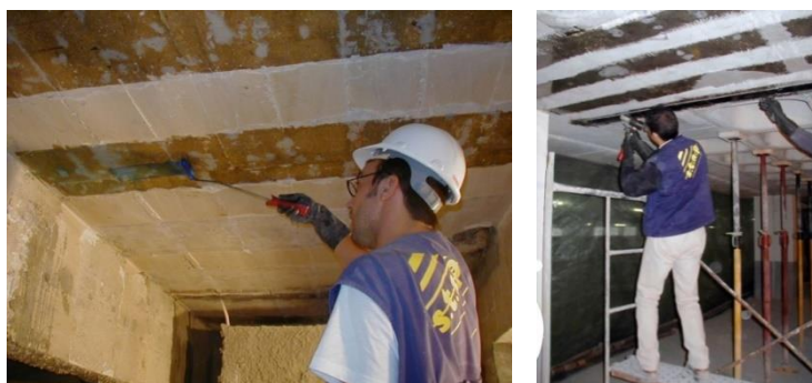
Figura 2.40 - Aplicação da resina (esq.), aplicação da fibra de carbono numa laje (dirt.)
