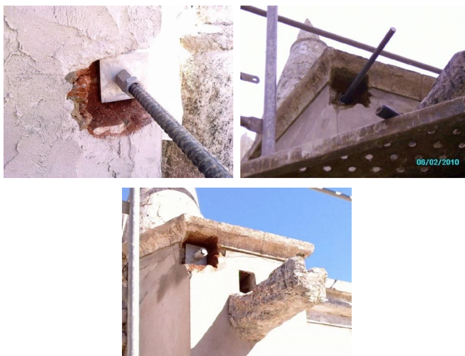
Figura 2.36 - Diferentes vistas de tirantes passivos (Reabilitação do Castelo de Viana do Alentejo, Planirest Construções Lda).
