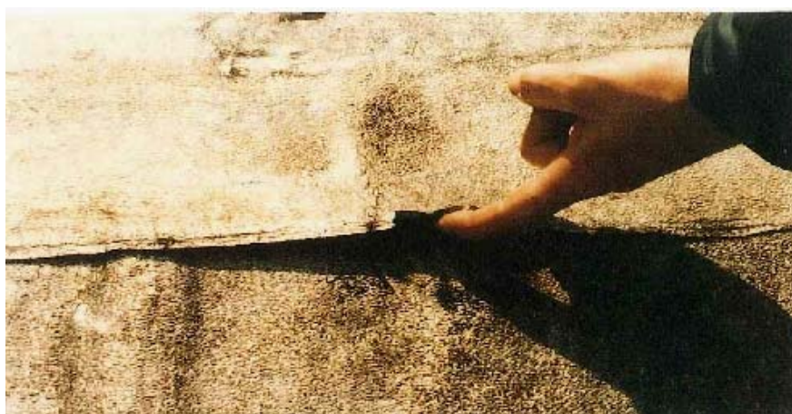
Fig. 51 - Descolamento da junta da impermeabilização [38]
