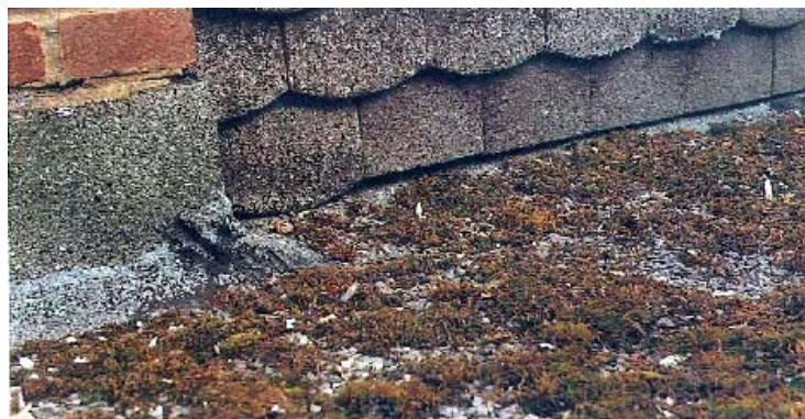
Fig. 54 - Deficiente manutenção (limpeza), originando acumulação de detritos na zona de menor cota da cobertura [38]
