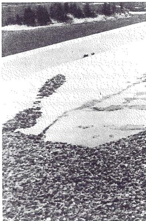
Fig. 45 - Arrastamento dos elementos da protecção pesada, por acção do vento [05]
