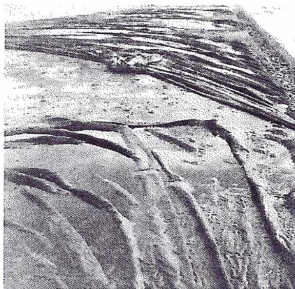
Fig. 47 - Arrancamento da impermeabilização [05]
