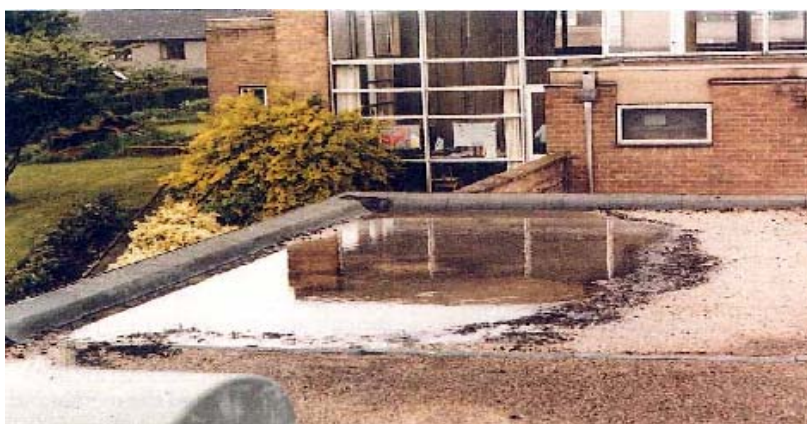
Fig. 48 - Deficiente escoamento resultante de má conformação da pendente [38]
