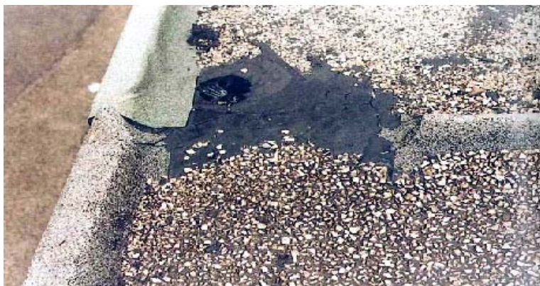
Fig. 53 - Anomalias junto a embocaduras de tubos de queda [38]
