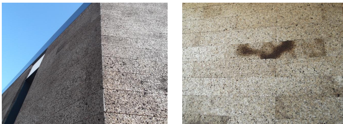
Figura 22 Rugosidade (esq.) e manchas carbonizadas (dir.)
