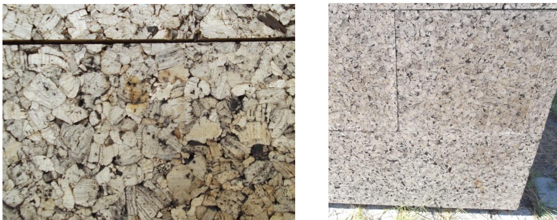
Figura 153 Manchas de cor amarela acastanhada
