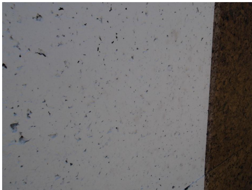
Figura 155 Manchas amareladas no verniz branco
