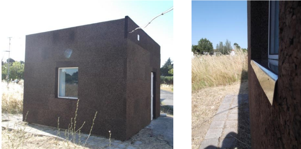
Figura 40 Desnível de placas das fachadas nascente e sul (esq.) e chapa zincada da janela (dir.)
