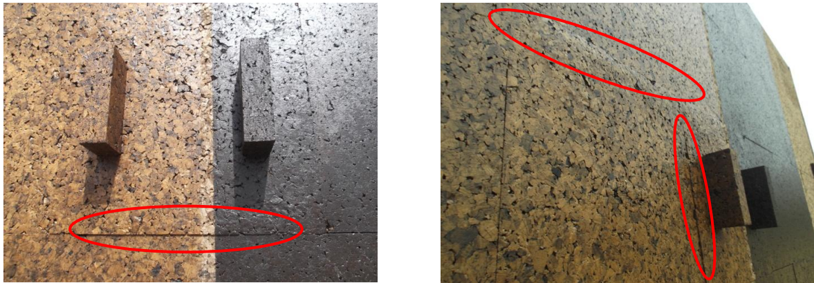
Figura 46 Consequências da colocação posterior da janela de visita
