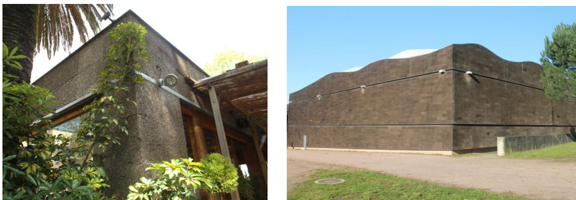
Figura 21 Alteração de cor e manchas
