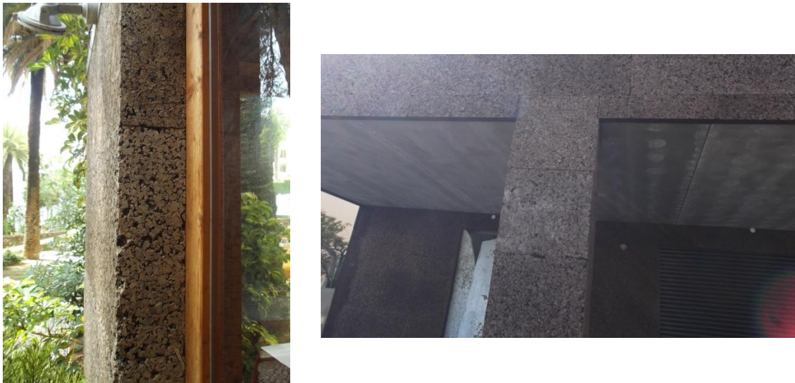
Figura 20 Faltas de material nas placas
