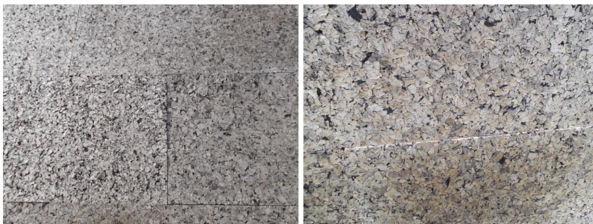
Figura 156 Textura, rugosidade e alteração do alinhamento da placa
