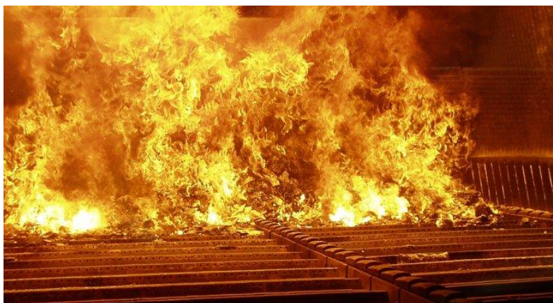
Figura 19: Câmara de Combustão.
