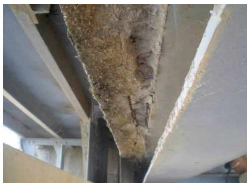
Figura 22: Armadura da Viga-Lancil fortemente corroída
