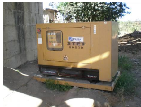
Figura 54: Gerador Diesel de 30 kva STET
