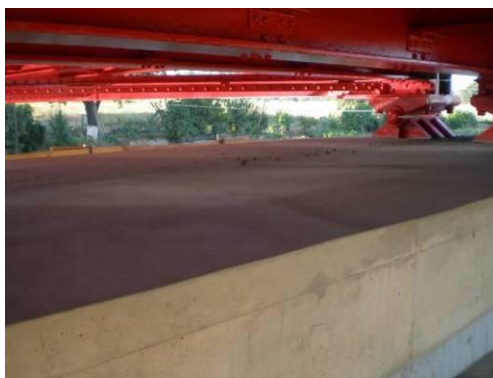
Figura 116: Superfície do betão após barramento geral com argamassa
