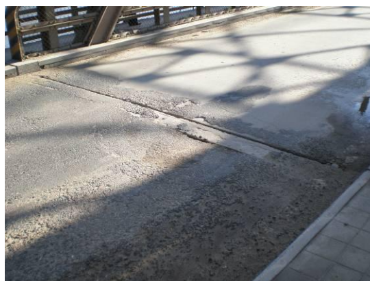
Figura 19: Fendas e quebras na junta de dilatação
