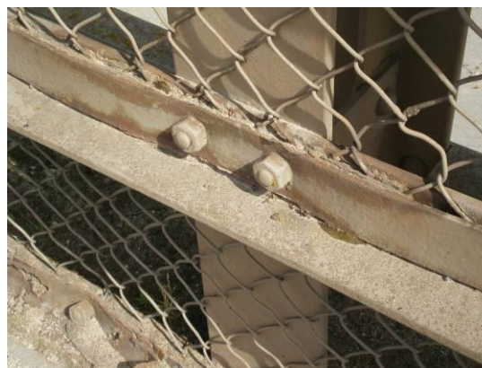
Figura 11: Rede metálica da Guarda Interior
