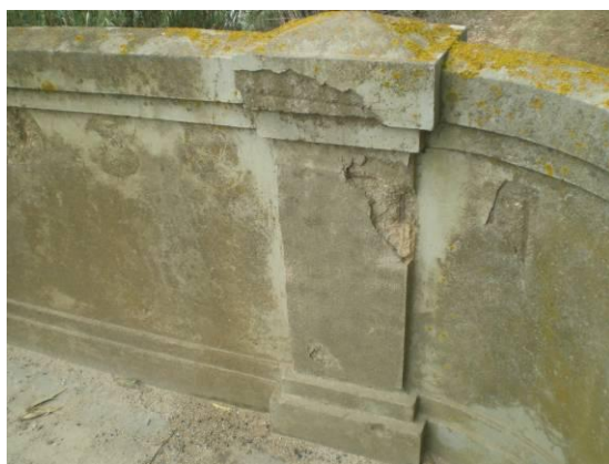
Figura 130: Aspecto geral da superfície dos elementos de betão, antes das limpeza
