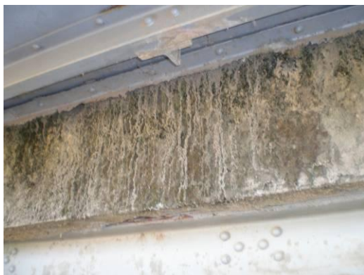
Figura 23: Superfície da Viga-Lancil bastante degradada
