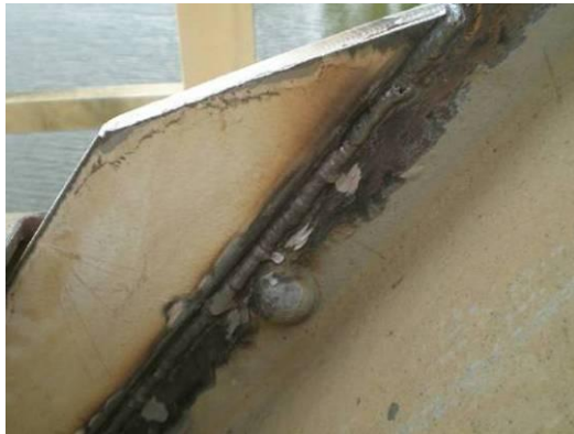
Figura 70: Aspecto visual da soldadura do reforço inferior ao perfil da diagonal
