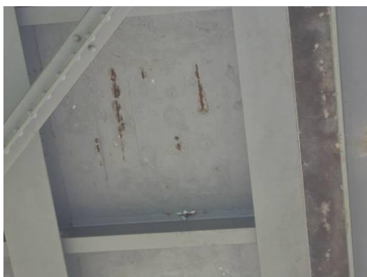
Figura 12: Corrosão da secção inferior da laje do tabuleiro
