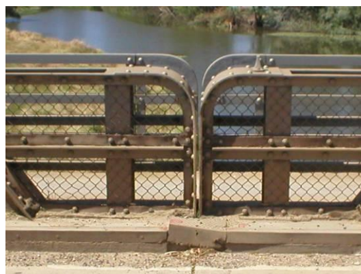
Figura 15: Cobres juntas bastante danificados e corroídos
