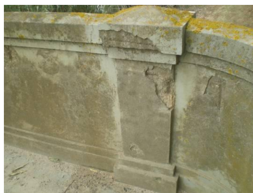
Figura 13: Delaminação do betão dos guarda corpos dos encontros
