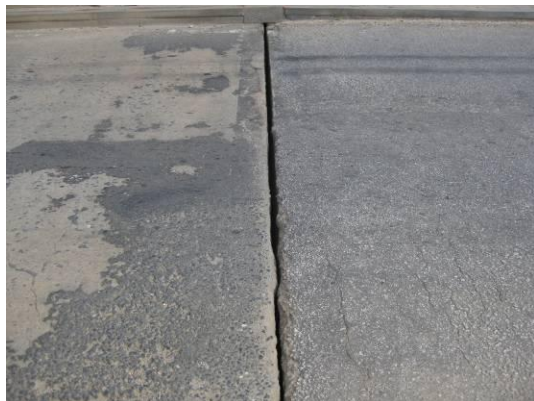
Figura 14: Inexistência de juntas de dilatação
