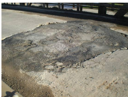
Figura 18: Betão do pavimento obstruído com asfalto
