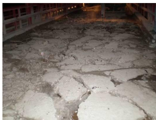
Figura 140: Detritos provenientes da camada de argamassa
