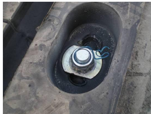
Figura 166: Aspecto da porca com freio após aplicação do momento de aperto
