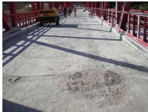
Figura 147: Superfície do pavimento isenta de detritos e matérias soltas
