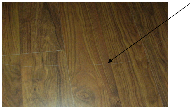
Figura 30– Patologia – Riscos [Habitação particular]
