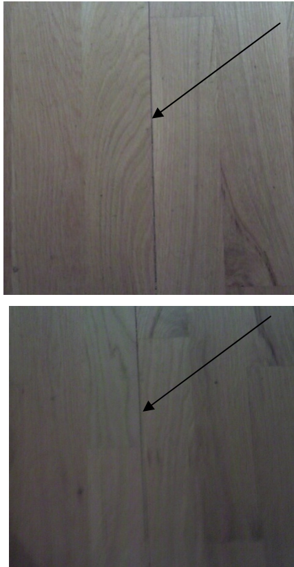
Figura 31– Patologia – Fendas [Habitação particular]
