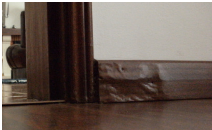
Figura 27– Patologia – Humidade no rodapé [Habitação particular]
