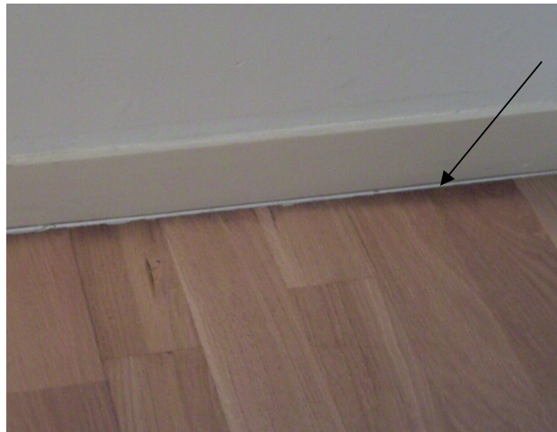
Figura 28 – Patologia - Humidade nas tábuas do revestimento flutuante [Habitação particular]
