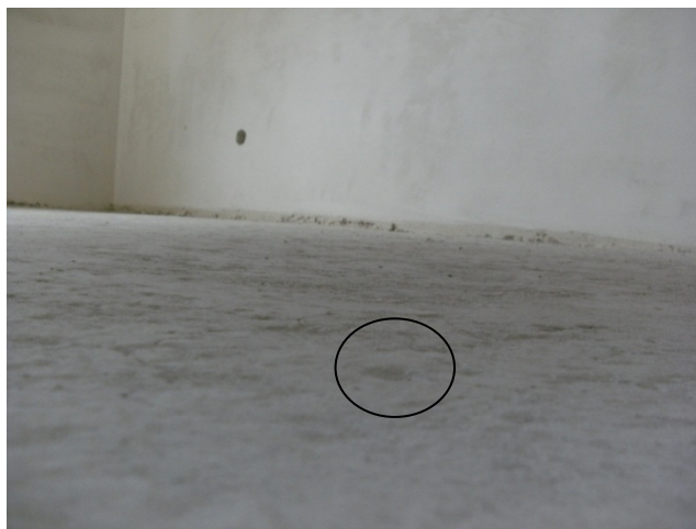
Figura 9 – Depressão na sub-base [Habitação particular]
