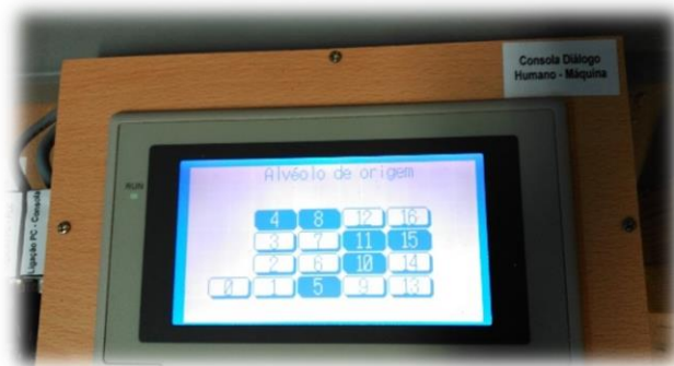
Figura 4.9 - Consola HMI utilizada no sistema.
