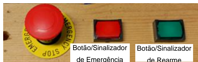
Figura 4.18 - Painel de comando.
