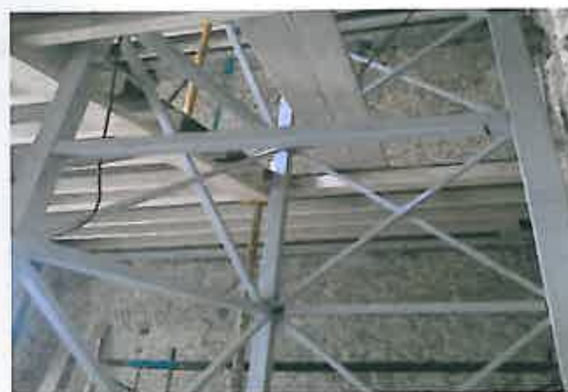
Figura 5.37 – Estrutura do elevador.
