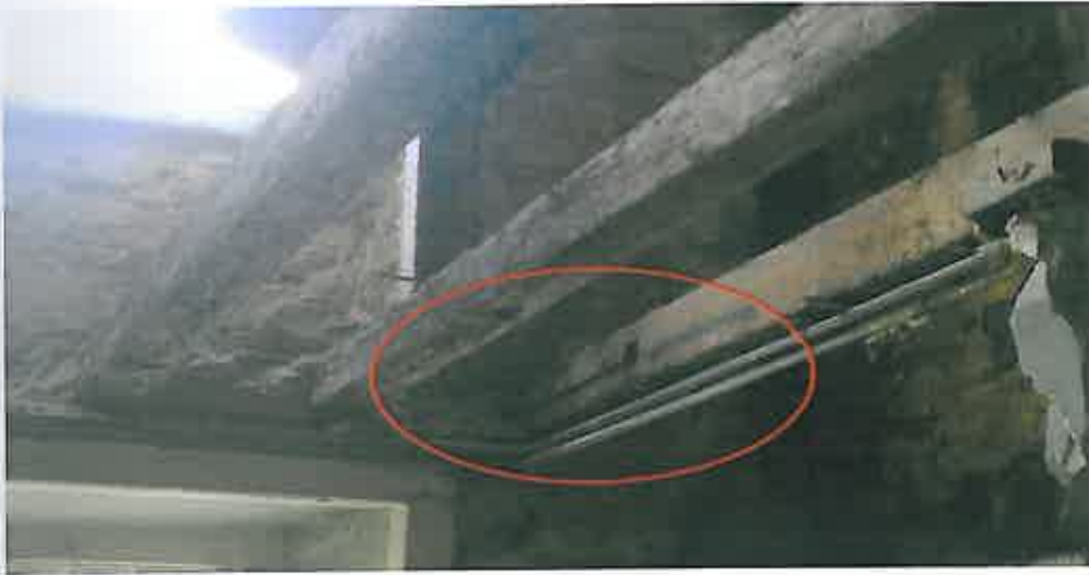
Figura 5.15 – Entrega das vigas de madeira em elevado estado de degradação.
