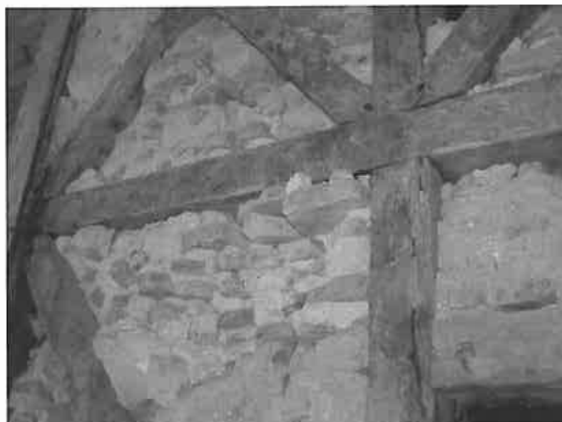
Figura 3.1 – Exemplo de preenchimento de Parede de Frontal como Argamassa de Cal e pequenas pedras e elementos cerâmicos.
