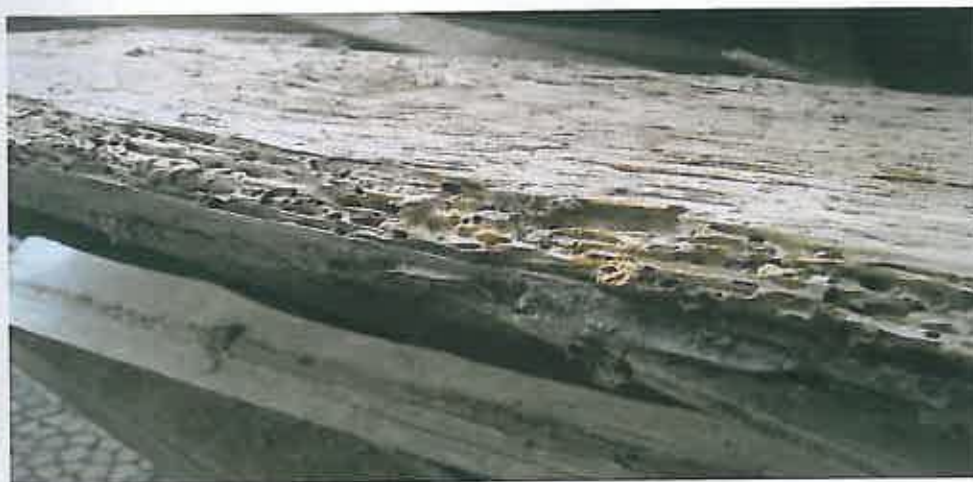
Figura 5.12 – Parte de viga de pavimento existente com início de Caruncho.
