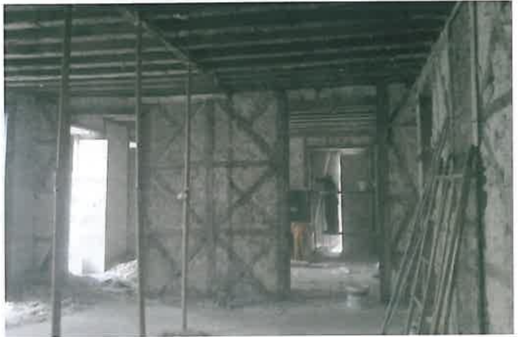
Figura 5.13 – Elementos estruturais após demolição dos revestimentos.
