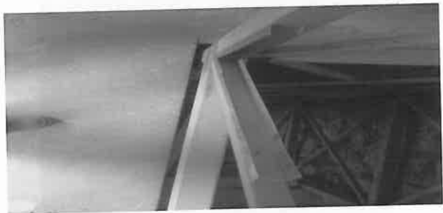
Figura 5.35 – Estrutura de madeira desligada da estrutura do elevador.
