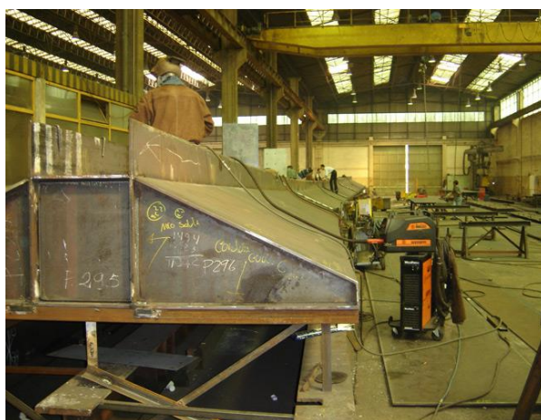
Figura 6.7 – Preparação e montagem de um dos troços do tabuleiro da ponte (Planeamento e Projetos de Engenharia, 2017).
