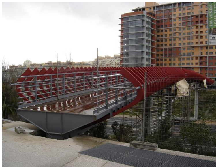
Figura 6.9 – Registo fotográfico no momento da montagem da ponte sobre um apoio temporário (Planeamento e Projetos de Engenharia, 2017).
