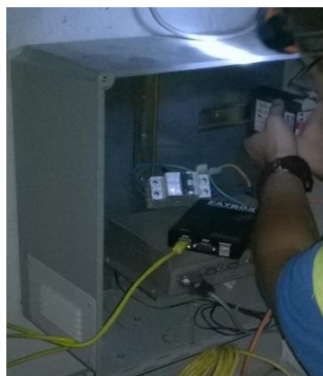
(b) computador instalado no local da obra
