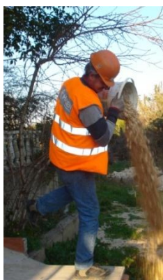
Figura XXV– Servente em posição de despejo do entulho (posição incorrecta)
