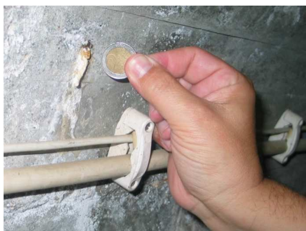
Figura 5.5: Barragem do Cabril. Pingo de gel resultante da reação expansiva (31 julho 2014).
