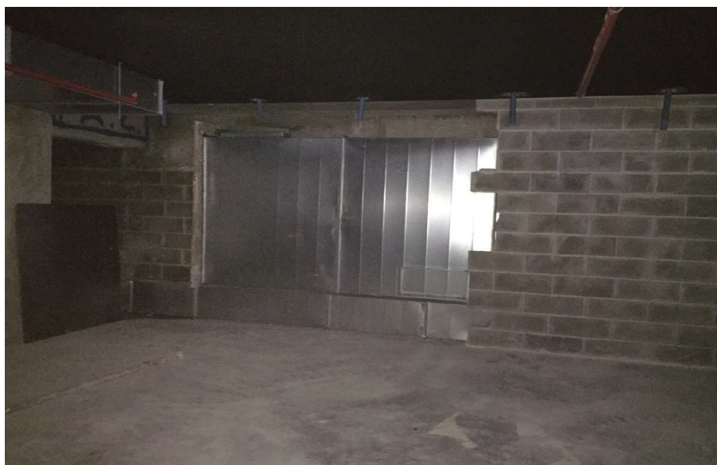
Figura 3-44 - Local onde foi necessário demolir pano de alvenaria de bloco para passar conduta de AVAC
