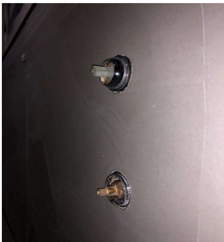
Figura 3-47 - Castelos das torneiras demasiado curtos para a espessura da parede
