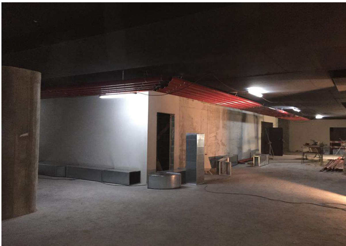
Figura 3-24 - Tubagem da rede de incêndio no Piso -4
