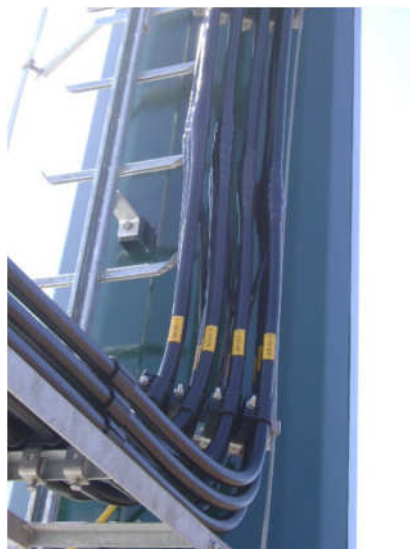
ILUSTRAÇÃO 4.4: PORMENOR DE ESCADA DE ACESO A TOPO DE TORRES E CAMINHO DE CABOS COAXIAIS.
