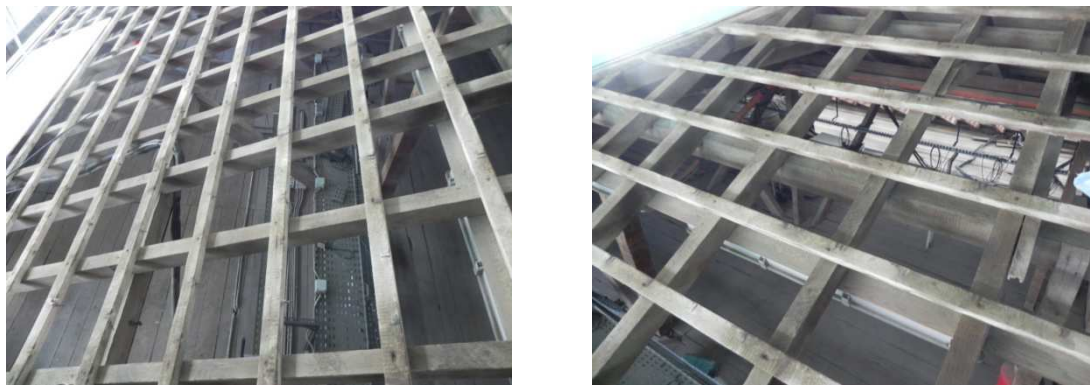
Figura 3.30 – Ripado de madeira da estrutura da cobertura.
