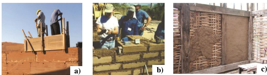
Figura 2.5 – Técnicas construtivas com terra (Torgal et al., 2009): a) parede em taipa; b) blocos de adobe; c) parede em tabique
