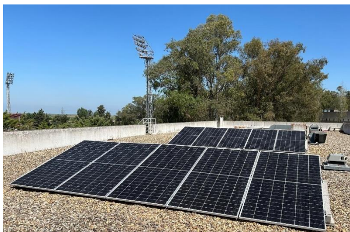
Figura 4.26 - Painéis Fotovoltaicos instalados.
