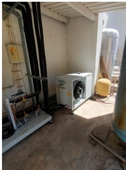
Figura 4.28 - Unidade Condensadora instalada no local.
