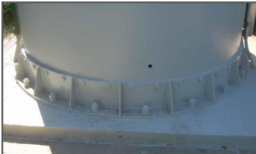
Figura 29 – Pormenor da ligação da base da estrutura por meio de flanges ligadas com chumbadouros roscados
