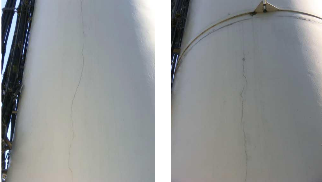
Figura 31 – Fendilhação em Torres em GFRC
