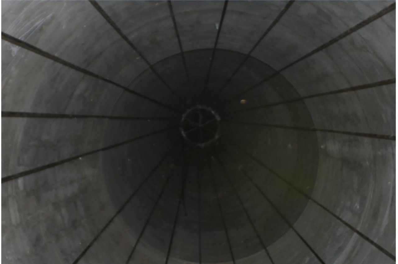
Figura 33 – Cabo de pós-tensão solto na zona oca de uma Torre em GFRC
