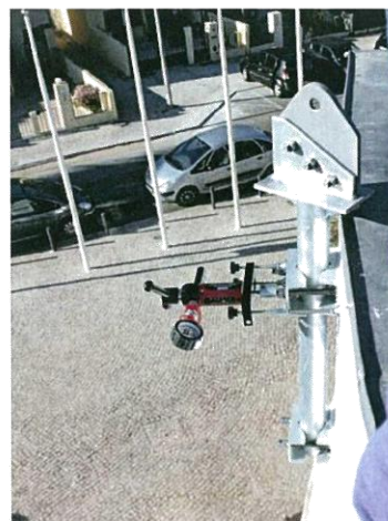
Foto 4: Equipamento em posição para aplicação de tracção em pernos de fixação de aparelho de ancoragem de espas (FE3).
