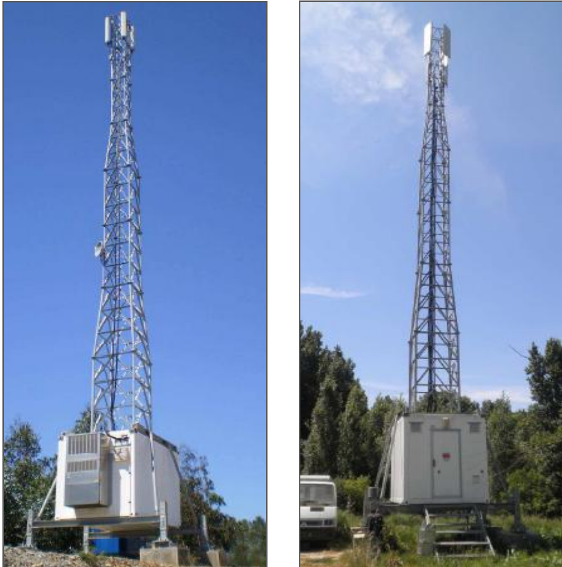
Figura 25 – Torres metálicas treliçadas autoportadas transportáveis
