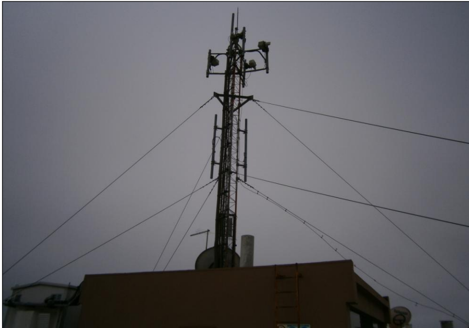
Figura 1 - Torre metálica treliçada espiada
