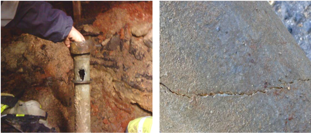
Figura 5.17 – Roturas em condutas de fibrocimento.
