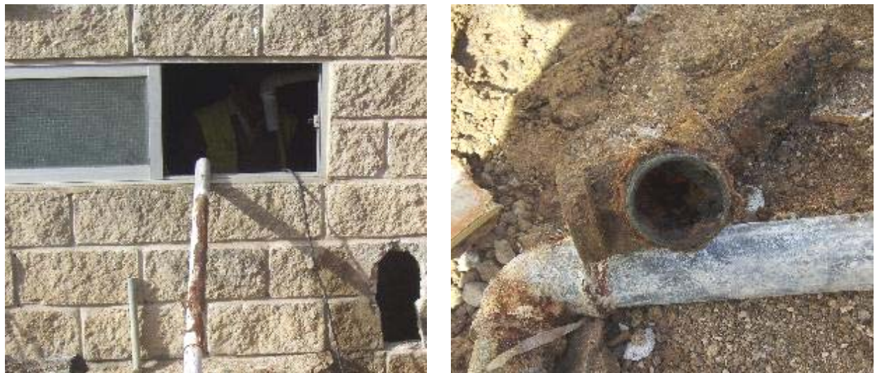
Figura 5.20 – Corrosão de ramal executado em ferro galvanizado.
