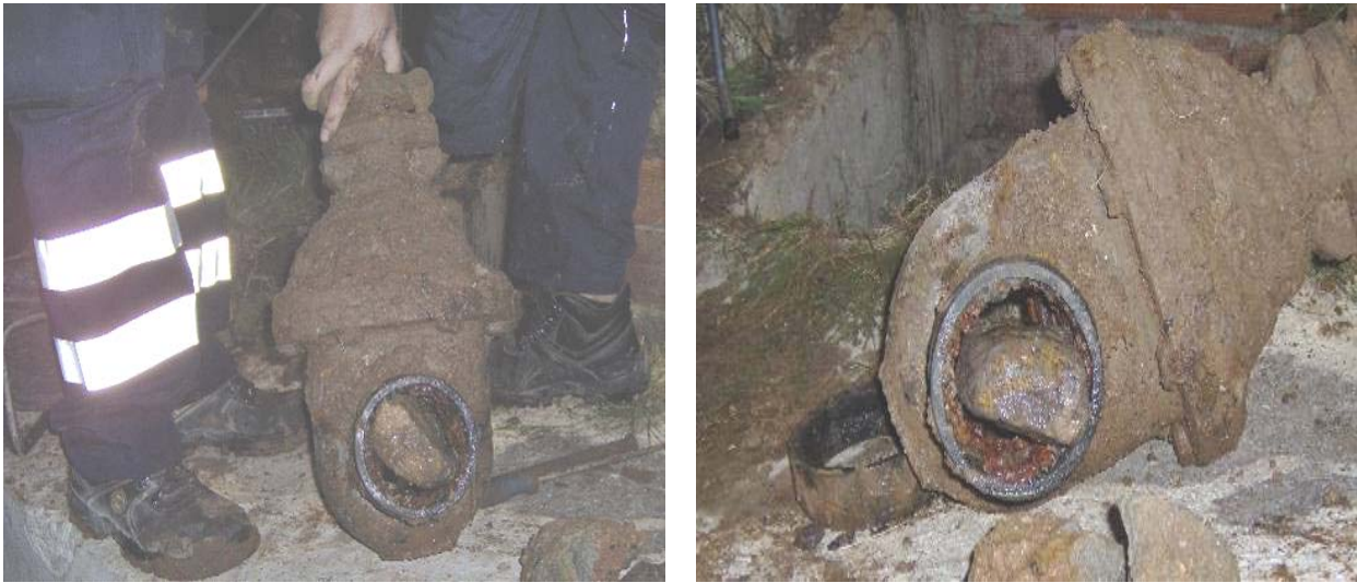
Figura 5.21 – Válvula obstruída por detritos.
