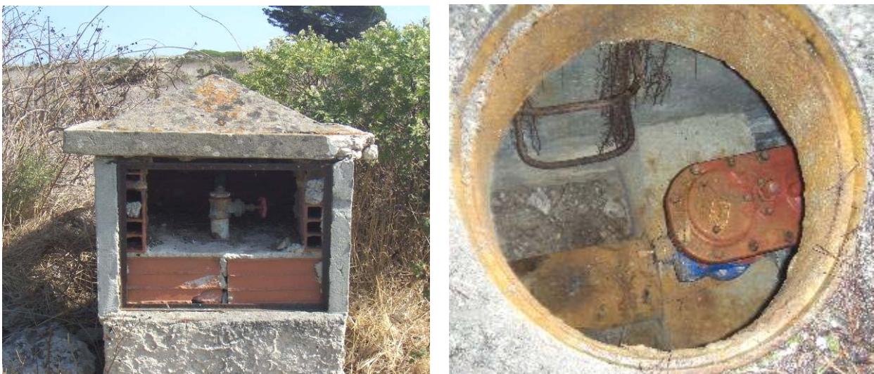
Figura 6.1 – Degradação por manutenção inadequada.
