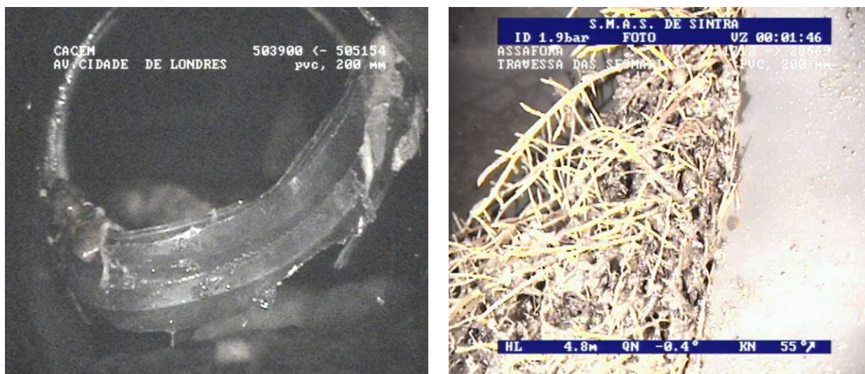
Figura 5.40 – Obstruções nos colectores. (Fonte: SMAS – Sintra)
