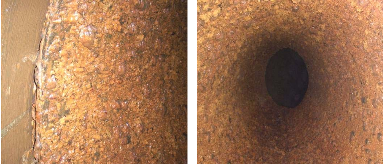
Figura 5.19 – Corrosão em conduta de aço com DN 1000.
