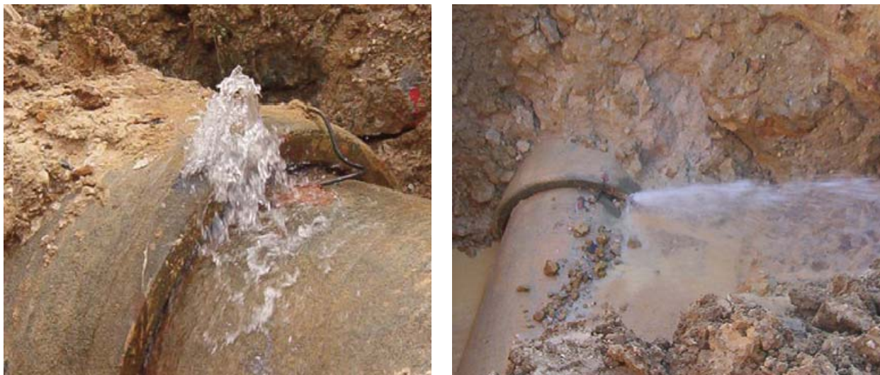
Figura 5.22 – Fugas em condutas de betão.
