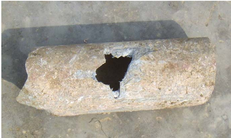
Figura 5.12 – Rotura por acção directa em tubagem de fibrocimento.
