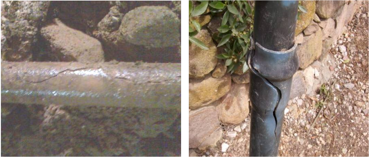
Figura 5.18 – Roturas em condutas de policloreto de vinilo.
