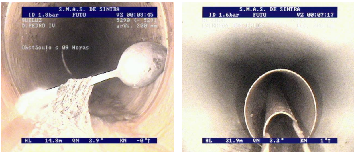
Figura 5.39 – Obstruções nos colectores. (Fonte: SMAS – Sintra)
