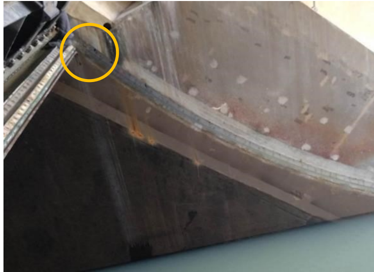
Figura 44 – Fissura DC1 – localização da fissura na zona de passagem de água e no plano de escorregamento da estanquidade
