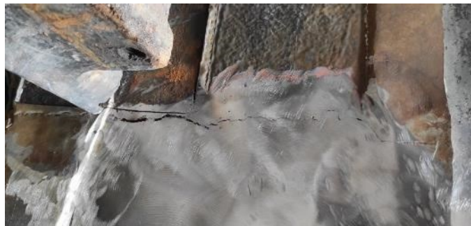
Figura 48 – Fissura observada nas peças fixas entre a parte inferior do aço carbono com a parte do aço martensítico
