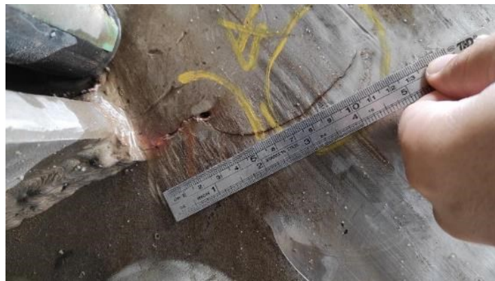
Figura 45 – Fissura DC1 – detalhe da fissura com cerca de 11cm de comprimento a começar na soldadura da travessa frontal com a peça fixa lateral
