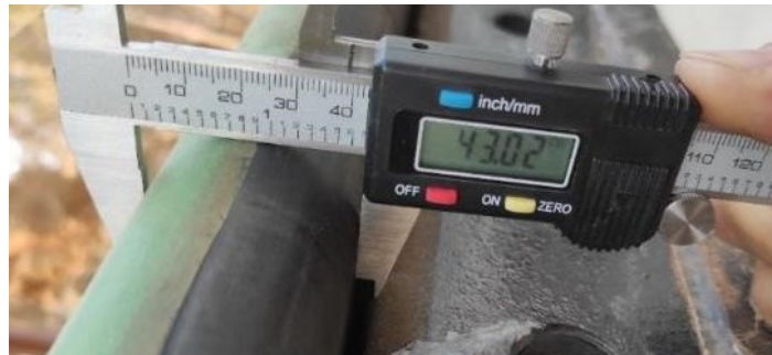
Figura 35 – Medição da dimensão do bolbo, para comparação com o valor de projeto, observando-se valor inferior ao expectável resultado de deformação permanente da estanquidade da margem esquerda DC01 – 43mm
