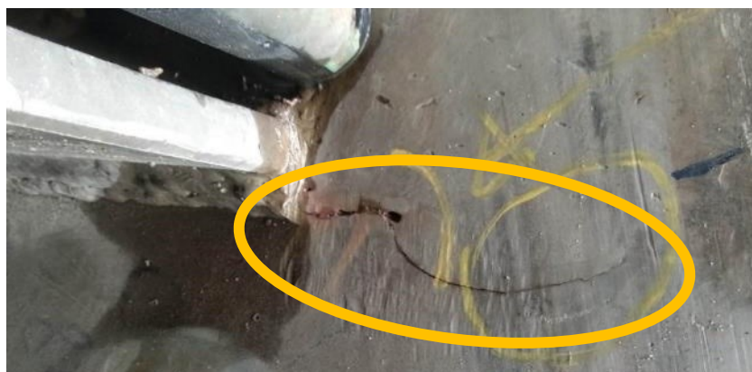
Figura 43 – Fissura na peça fixa
