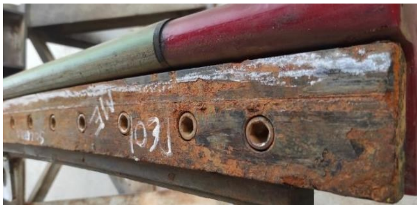
Figura 34 – Barra de aperto: riscos, sulcos e remoção da proteção anticorrosiva
