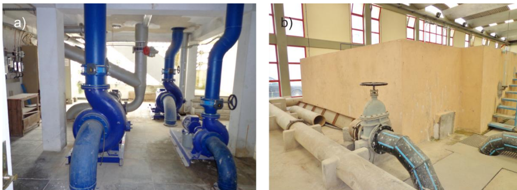
Figura 3.4: (a) Bombas do sistema geral de abastecimento do NRE e (b) válvula de cunha a montante do modelo físico do Foz Tua.
