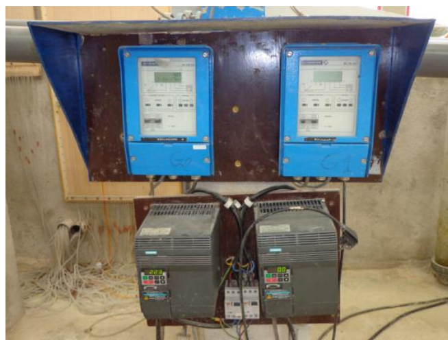
Figura 3.5: Conjunto de caudalímetros associados a cada conduta e variadores de velocidades.
