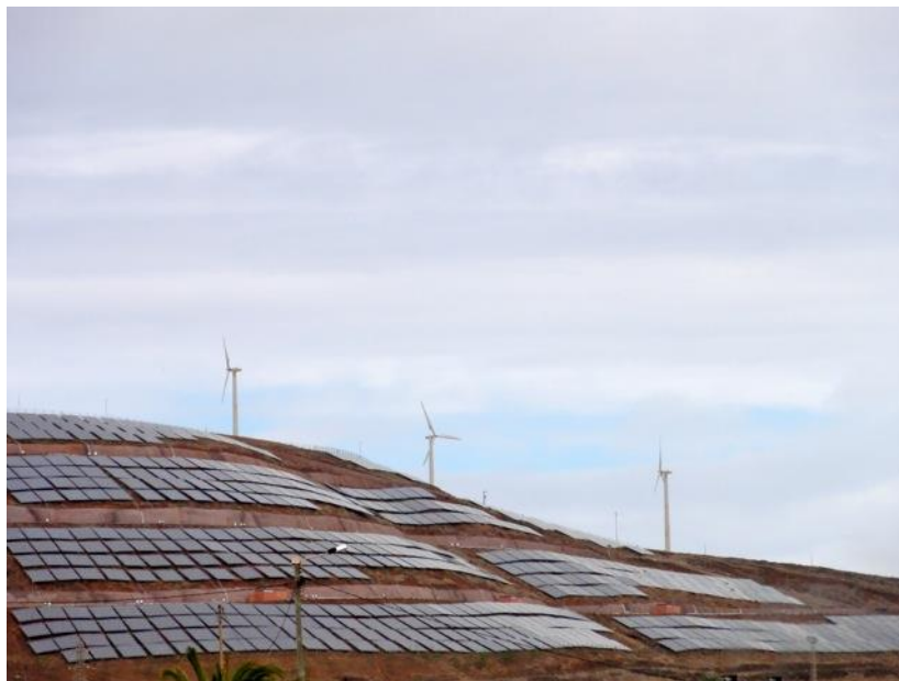
Figura 3.18 – Parque Fotovoltaico do Caniçal [28]
