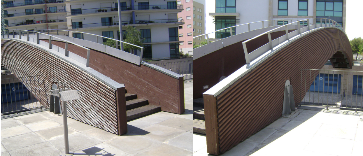
Figura 50 - Vista a Nascente - Face Sul deteriorada - à esquerda e Face Norte sem problemas - à direita (Almeida, 2013)
