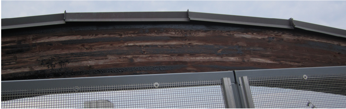
Figura 56 - Degradação da viga principal (Almeida, 2013)
