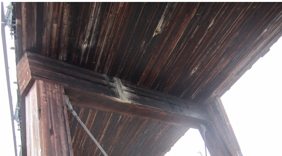
Figura 57 - Degradação da plataforma da ponte/Pate inferior da ponte (Almeida, 2013)
