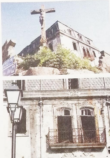
EM RISCO. Casa do Passal está em situação extraordinariamente precária
