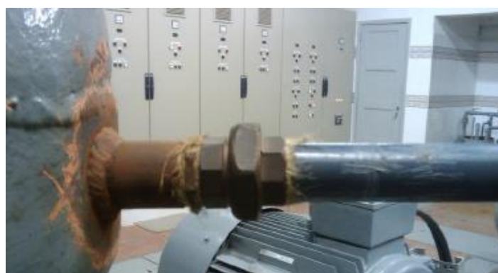
Figura 1.3 - Corrosão por junção de metais diferentes
