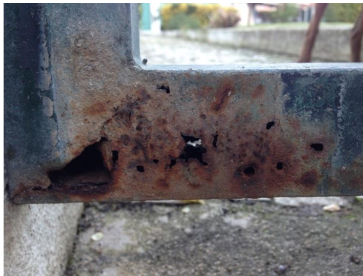
Figura 1.1 – Figura ilustrativa da corrosão de uma estrutura metálica constituinte de um portão
