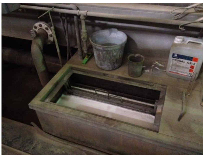
Figura 2.5 – Depósito de preparação do banho de desengorduramento e conversão do túnel de aspersão utilizado no tratamento das estruturas metálicas anterior à pintura
