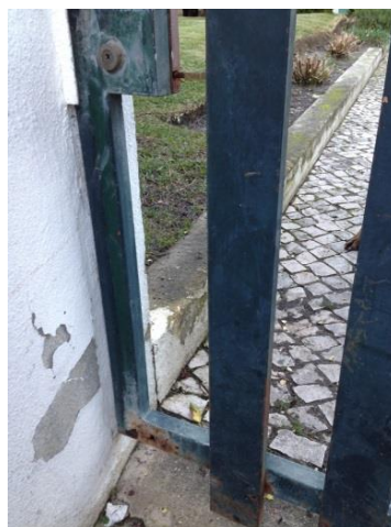
Figura 1.2 – Figura ilustrativa da corrosão de uma estrutura metálica constituinte de um portão
