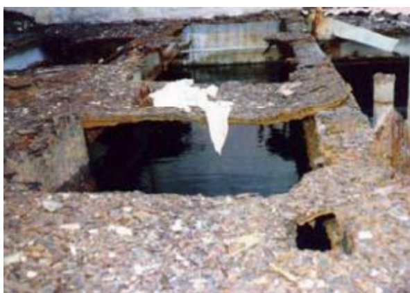
Figura 1.4 – Exemplo de corrosão uniforme [Jones, Denny A.,1996]
