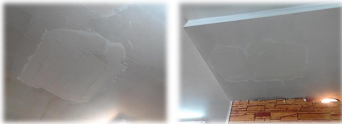
Figura 39 - Remoção pontual de tecto falso para passagem de tubagem
