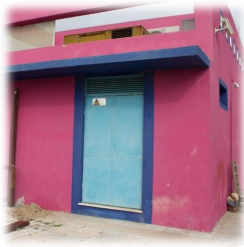
Figura 6 - Posto de Transformação
