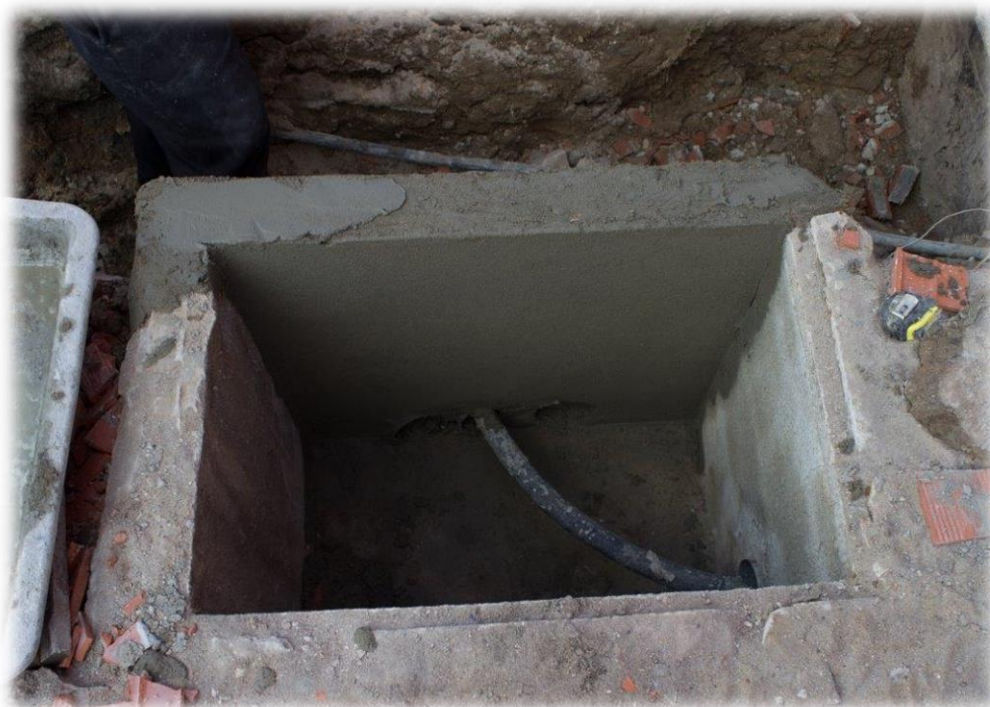
Figura 118 - Caixa de visita ao ramal de alimentação eléctrica
