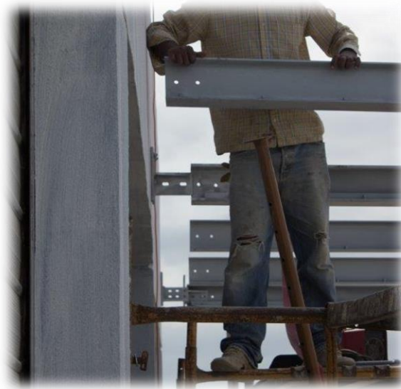
Figura 18 - Espaçamento da estrutura metálica em falta
