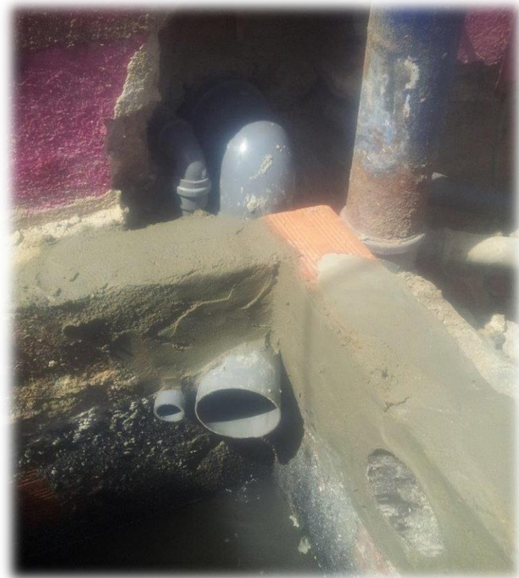
Figura 120 – Caixa de visita com esgotos miúdos da cozinha devidamente organizados
