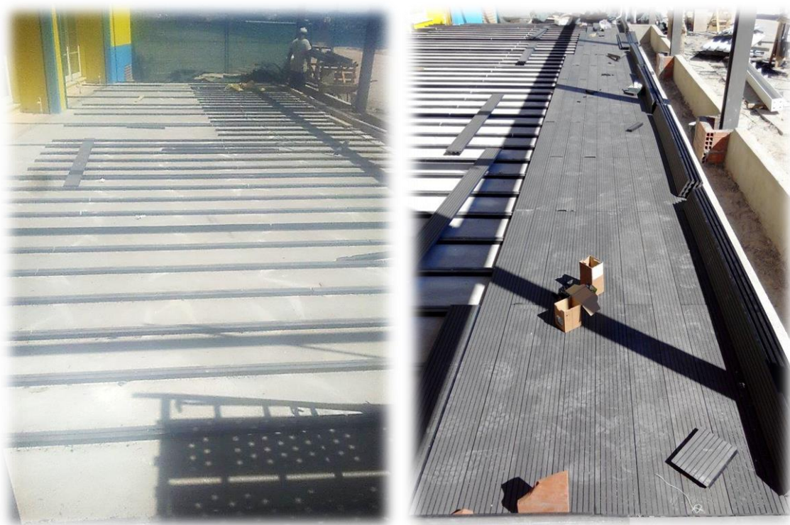
Figura 89 - Colocação de sarrafos (à esq.) Aplicação das régua do deck (à dt.)
