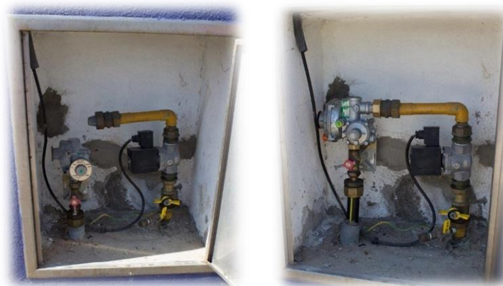
Figura 123 - Redutor de pressão partido devido a translação vertical (à esq.) Redutor de pressão novo (à dt.)
