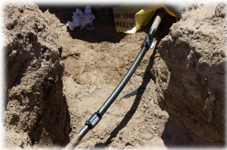
Figura 125 - Rotura já devidamente neutralizada por intermédio de dois ligadores
