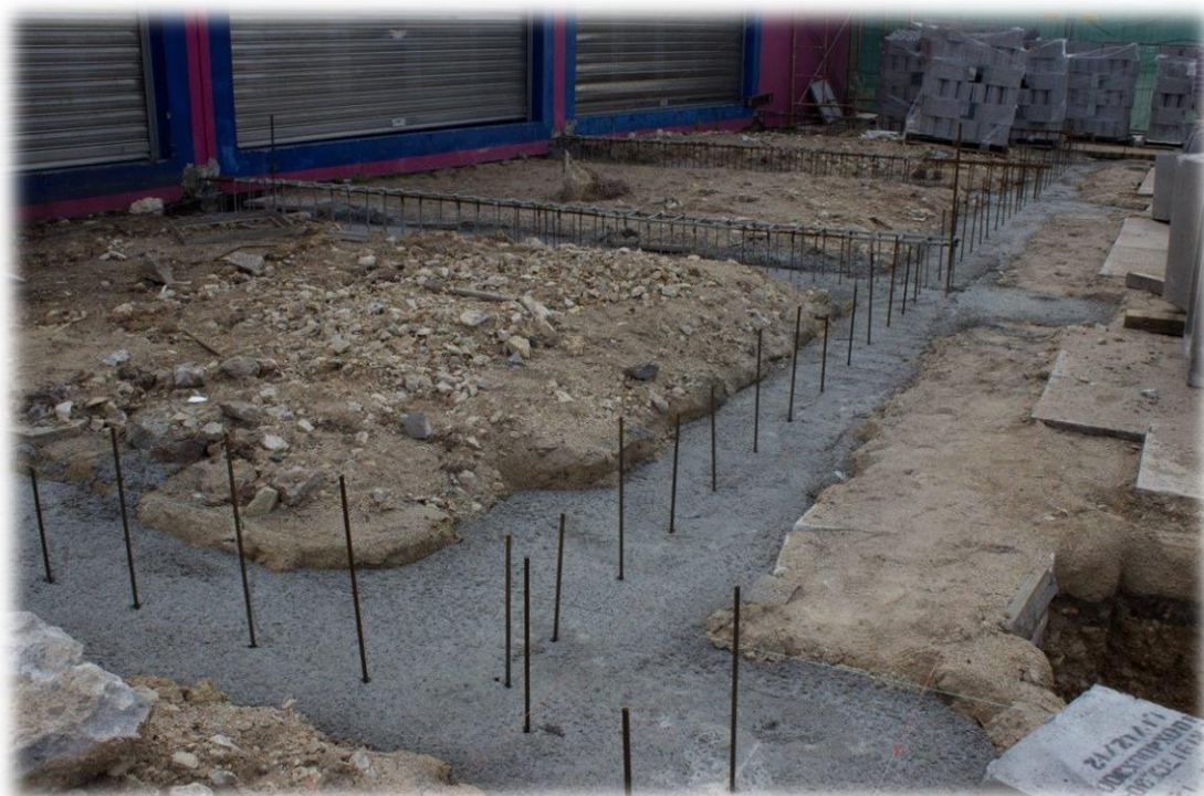
Figura 54 - Aspecto final das fundações já concluídas com armadura de espera para o lintel
