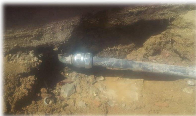
Figura 135 - Rotura já solucionada com acessório de ligação
