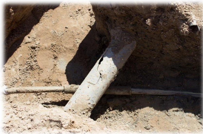
Figura 116 - Troço de tubagem com rotura
