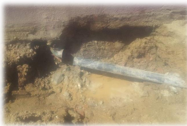
Figura 134 - Local da rotura momentos antes da reparação
