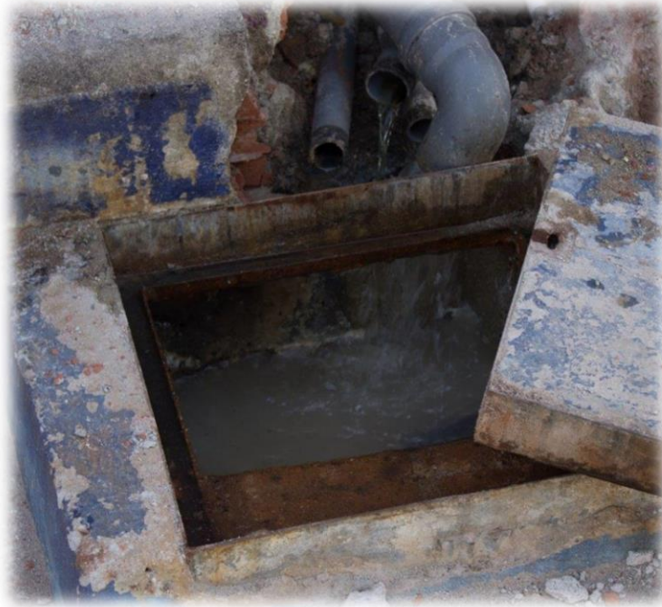
Figura 119 - Caixa de visita com deficiente encontro de esgotos miúdos da cozinha
