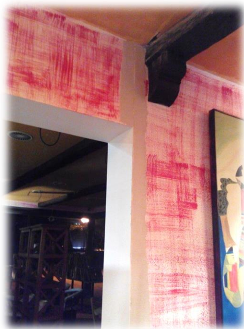
Figura 128 - Remates de estuque após remoção da divisória falsa
