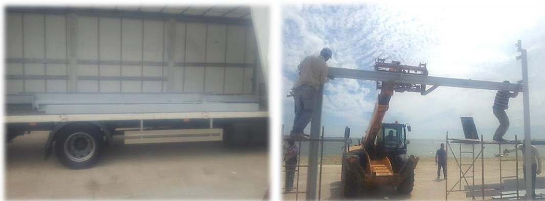
Figura 71 – Chegada dos elementos da estrutura (à esq.) Montagem da estrutura com auxílio da Multifunções (à dt.)
