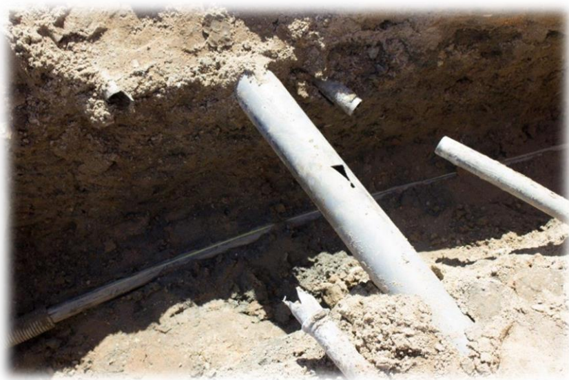
Figura 117 - Troço de tubagem pluvial com rotura
