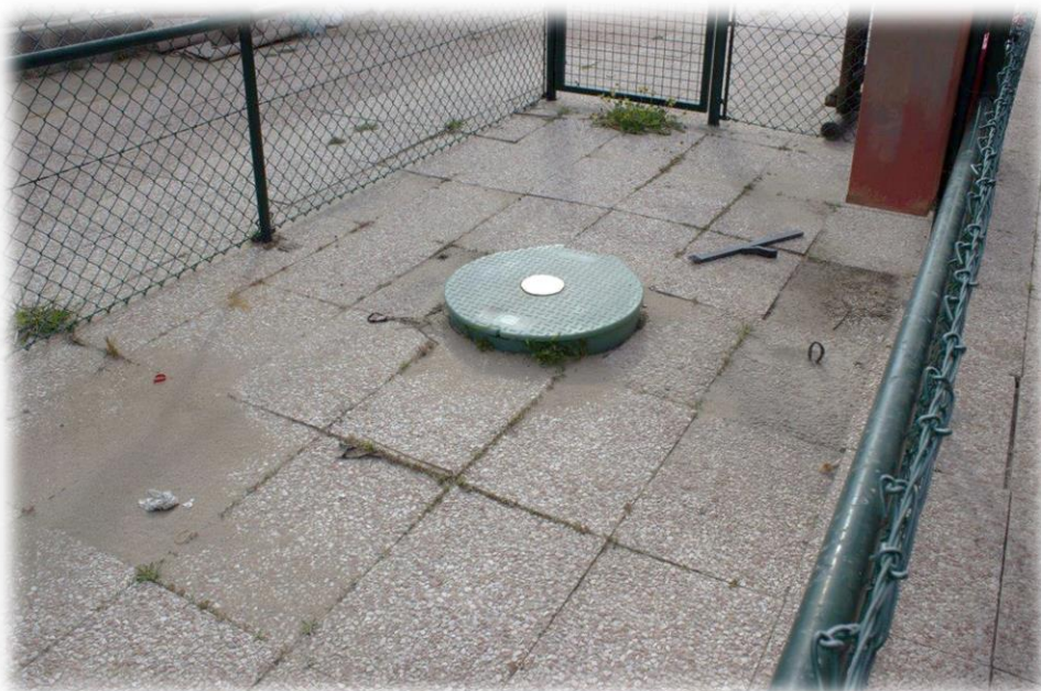
Figura 5 - Reservatório enterrado de Gás Propano
