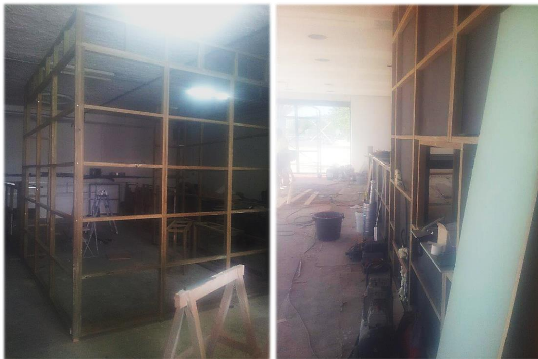
Figura 100 - Produção da estrutura na oficina (à esq.) Fase de montagem da estrutura na sua localização final (à dt.)
