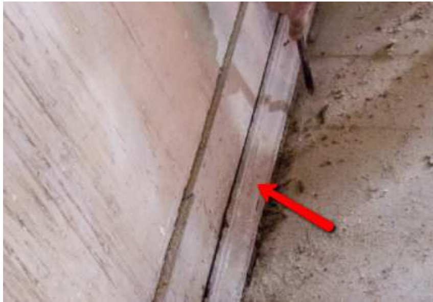
Figura 57 - Remate da junta entre pavimento e rodapé ("Rua Marquês de Sá da Bandeira 110," 2016)
