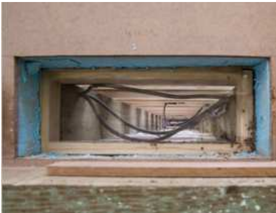
Figura 38 - Janelas acrílicas para inspeção
