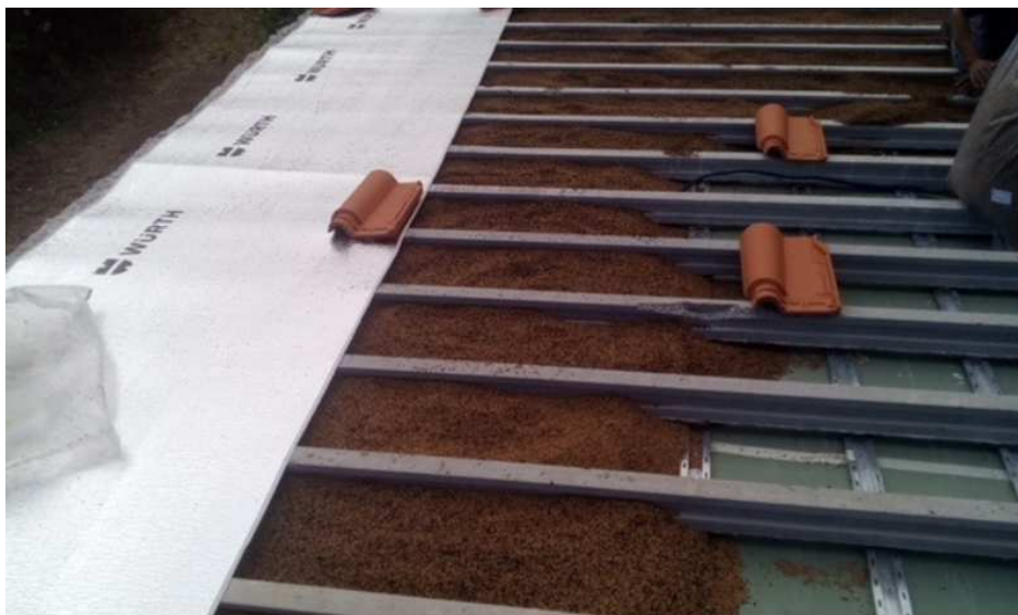
Figura 78 - Aplicação da mistura em estudo entre vigas de betão armado selada com manta de PEF aluminizada como reforço de impermeabilização
