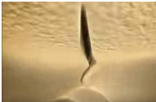
Figura 11 - Espuma de PUR com fissuras por retração (“Documentário HGTV,” 2015)
