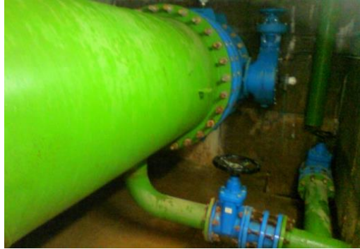
Figura 33 - Válvula de seccionamento do tipo borboleta, com circuito bypass seccionado por válvula de cunha.
