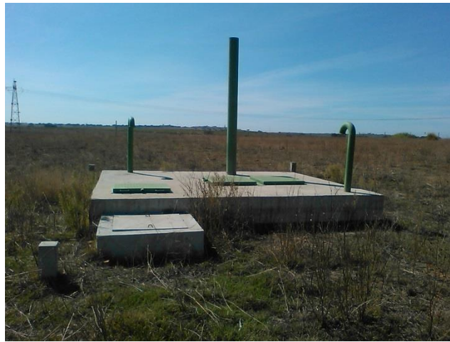
A 8 - Caixa da válvula de seccionamento da conduta principal da rede rega à saída do reservatório.
