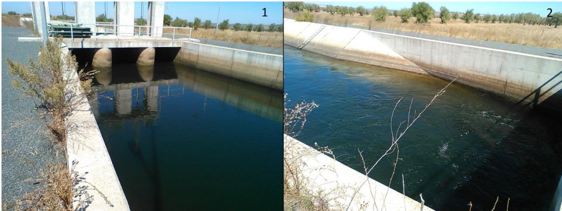
Figura 20 - Comporta de Ensecadeira, para regulação da altura da água por perda de carga: 1) comporta a montante; 2) canal a jusante da comporta.
