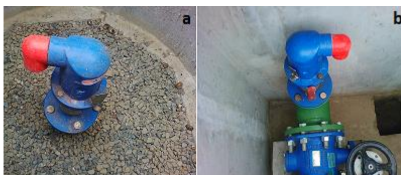
Figura 43 – Ventosas do Bloco de Rega de Faro do Alentejo: a) ventosa no ponto alto de uma conduta; b) ventosa no hidrante do tipo III.
