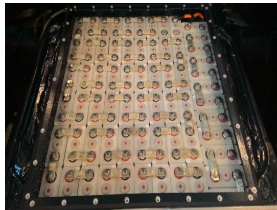
Figura 80 – Caixa das baterias (Traseira do veículo)
