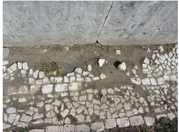
Figura 2- Ausência de elementos de calçada no canal de drenagem, na fachada lateral direita. Fonte: Autor, outubro 2017.
