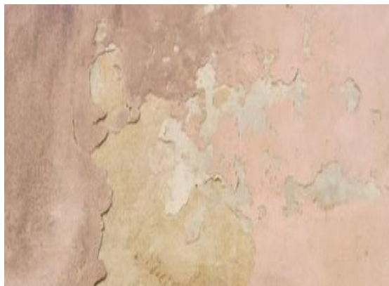
Figura 2- Destacamento de tinta e reboco. Fonte: Autor, outubro 2017.
