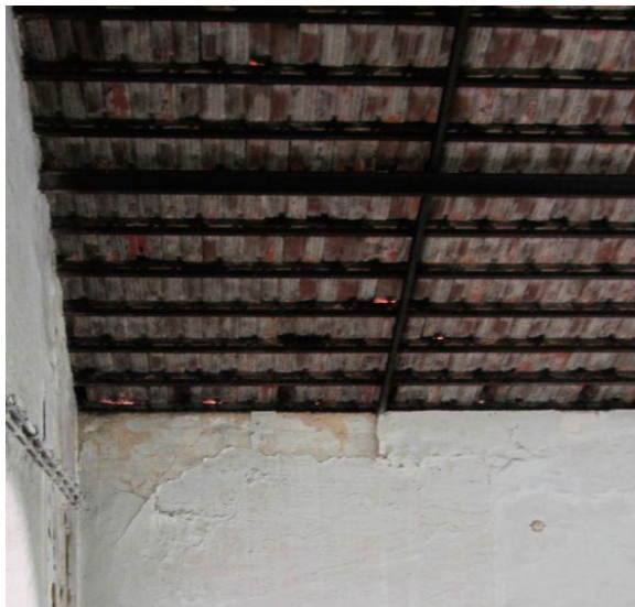
Figura 2- Vista interior da cobertura, realçando alguns pontos de entrada de luz entre as telhas, podendo ser local de infiltrações de águas pluviais, tomando como referência as humidades presentes no paramento adjacente. Fonte: Autor, outubro 2017.
