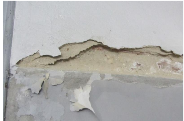
Figura 2- Destacamento do reboco, no paramento no interior da arrecadação. Fonte: Autor, outubro 2017.
