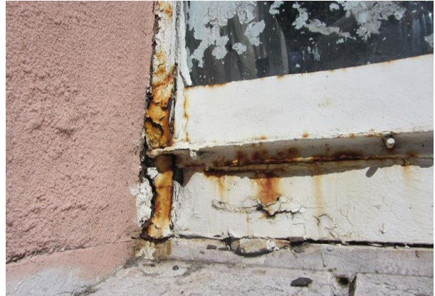
Figura 2- Vão de janela corroído na fachada lateral direita, apresentando uma elevada degradação e descolamento do paramento. Fonte: Autor, outubro 2017.
