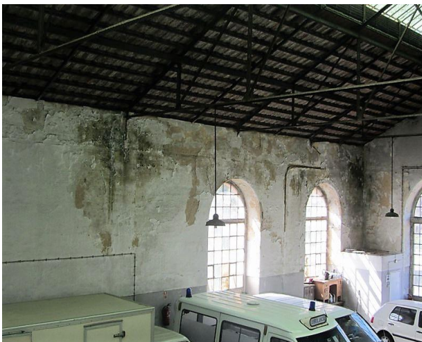
Figura 2- Criptoeflorescências na zona mais afetada do edifício. Fonte: Autor, outubro 2017.
