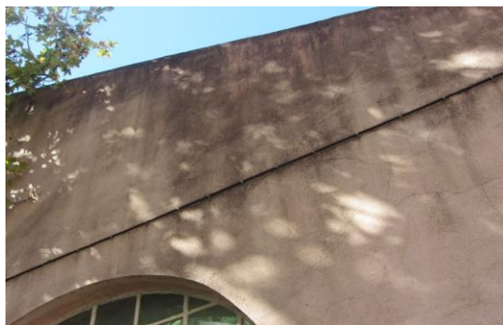
Figura 1- Mancha de humidade na parte superior da fachada tardoz. Fonte: Autor, outubro 2017.
