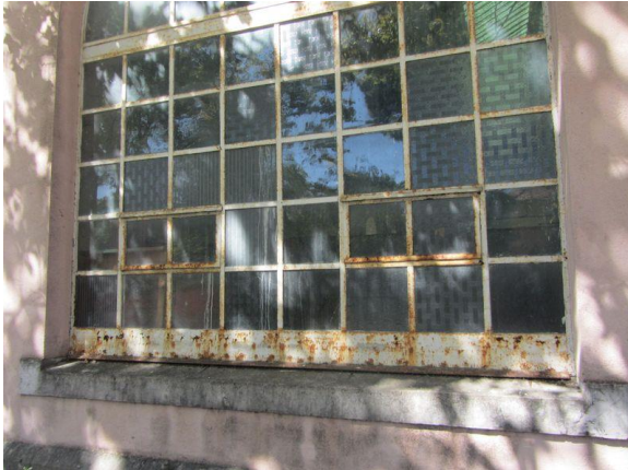
Figura 1- Vão de janela na fachada tarдоз corroída. Fonte: Autor, outubro 2017.
