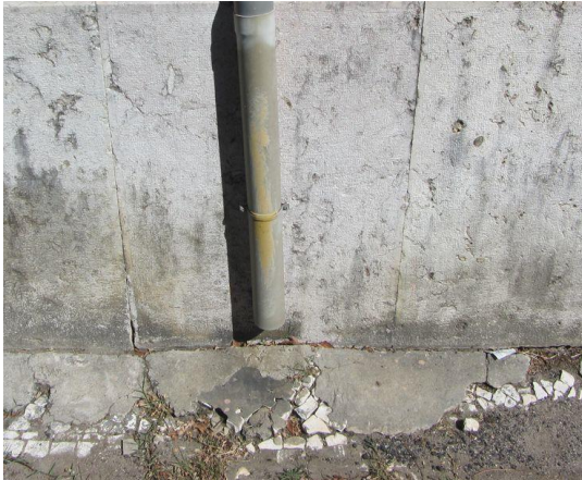
Figura 1- Revestimento de argamassa cimentícia já degradada por baixo do tubo de queda. Fonte: Autor, outubro 2017.
