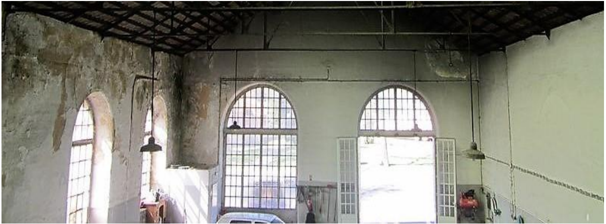
Figura 1-Vista geral das criptoeflorescências presentes na parte superior dos paramentos, em estande avançado com degradação do reboco e colonização biológica em certas zonas. Fonte: Autor, outubro 2017.
