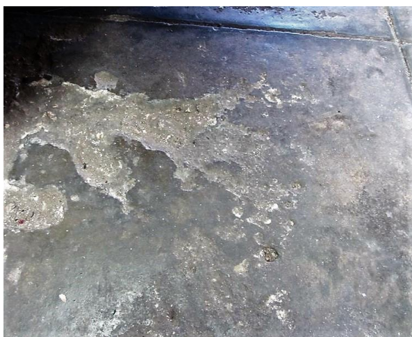
Figura 1- Desgaste do pavimento com destruição da camada superficial da betonilha. Fonte: Autor, outubro 2017.
