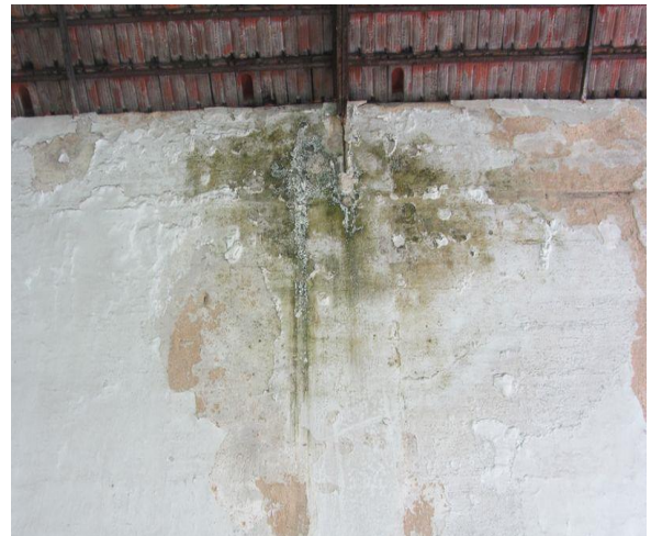
Figura 3- Pormenor de criptoeflorescências com degradação do reboco e colonização biológica. Fonte: Autor, outubro 2017.
