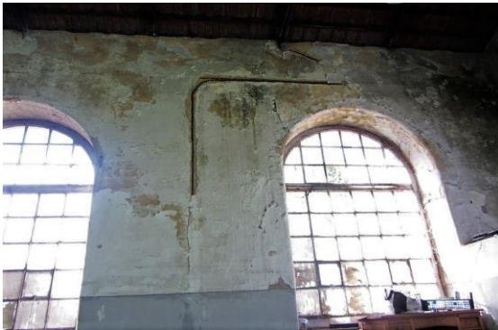
Figura 1- Oxidação dos tubos que protegem os fios das instalações elétricas, que com a expansão do metal devido à corrosão fez soltar o reboco que cobria essa zona, situado na parede sudeste. Fonte: Autor, outubro 2017.
