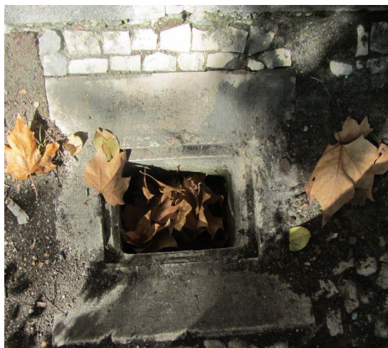
Figura 2- Caixa de visita sem grelha e com deposição de folhas que poderão causar entupimentos na rede de esgotos, situada na fachada tardoz. Fonte: Autor, outubro 2017.
