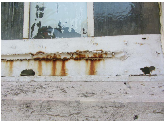
Figura 3- Vão de janela com corrosão avançado apresentando perda de material. Fonte: Autor, outubro 2017.
