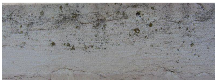
Figura 2- Fissuras presentes no peitoril de um vão de janela. Fonte: Autor, outubro 2017.
