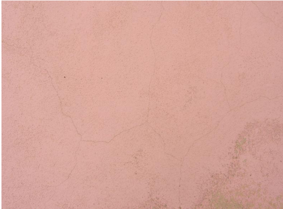
Figura 1- Fissuração na parede de fachada principal. Fonte: Autor, outubro 2017.
