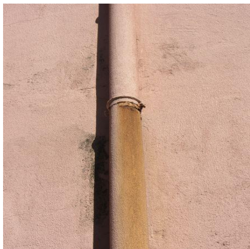
Figura 1- Rotura de tubo de queda, localizado na fachada lateral direita. Fonte: Autor, outubro 2017.
