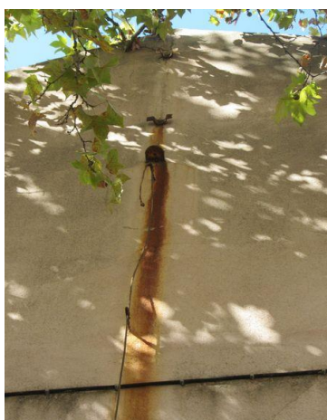
Figura 3- Mancha ferrosa na fachada tardoz. Fonte: Autor, outubro 2017.
