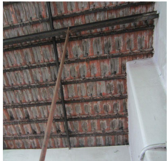
Figura 3- Vista interior da cobertura, notando o facto de todas as telhas apresentarem manchas escuras de humidade. Fonte: Autor, outubro 2017.
