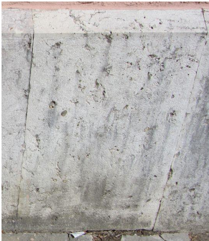
Figura 1- Alveolização no soco da fachada principal. Fonte: Autor, outubro 2017.
