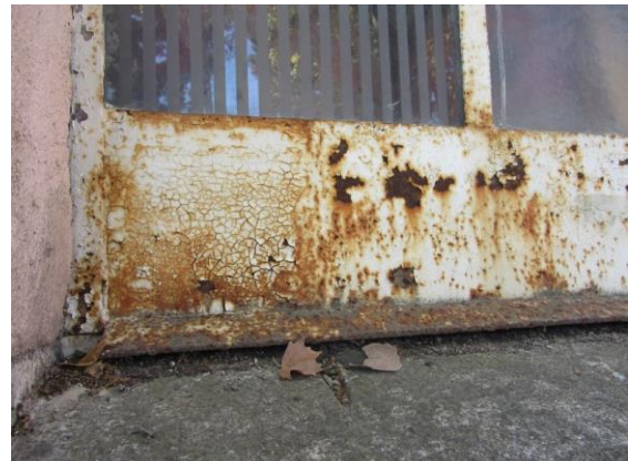
Figura 4- Vão de janela apresentando corrosão muito desenvolvida, tendo já em variados locais danificado por completo o revestimento de tinta. Fonte: Autor, outubro 2017.
