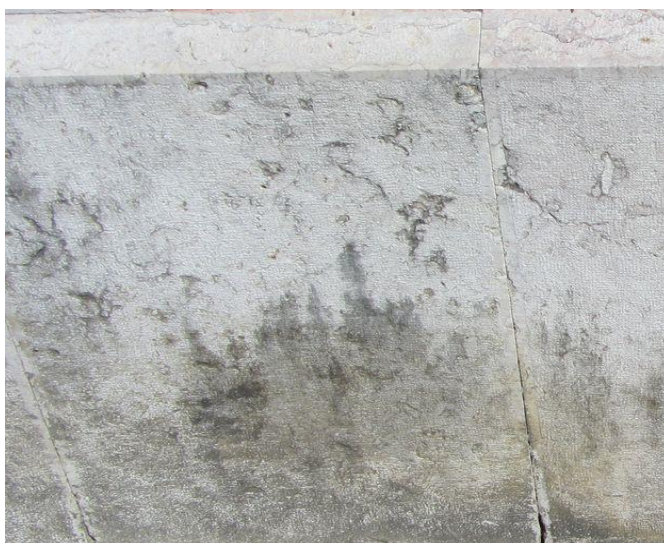
Figura 1- Fissuras no soco da fachada. As fissuras não apresentam largura superior a 0,5mm. Fonte: Autor, outubro 2017.
