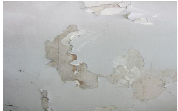
Figura 4- Destacamento de tinta, no paramento interior do lado esquerdo. Fonte: Autor, outubro 2017.
