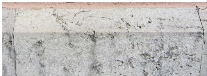
Figura 3- Pormenor de alveolização na fachada no soco da fachada principal. Fonte: Autor, outubro 2017.
