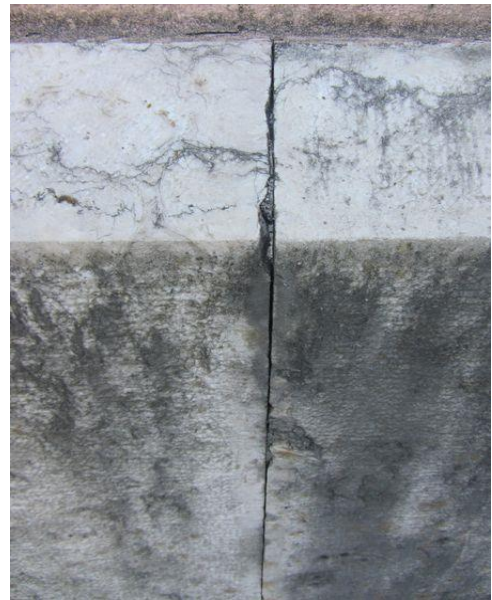
Figura 2- Ausência parcial e total de material de preenchimento de juntas, na fachada principal. Fonte: Autor, outubro 2017.
