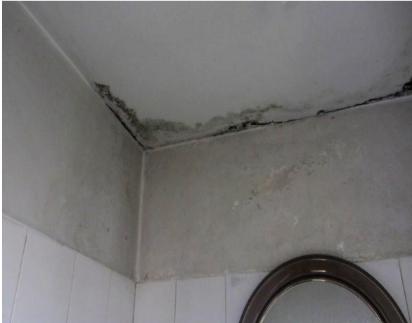
Figura 1-Humidades presentes no teto da instalação sanitária. Fonte: Autor, outubro 2017.
