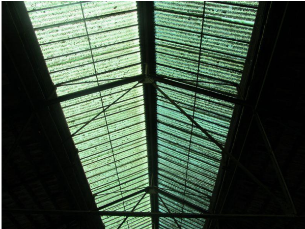
Figura 1- Chapas acrílicas da cobertura apresentando mudança de cor e detritos - interior. Fonte: Autor, outubro 2017.
