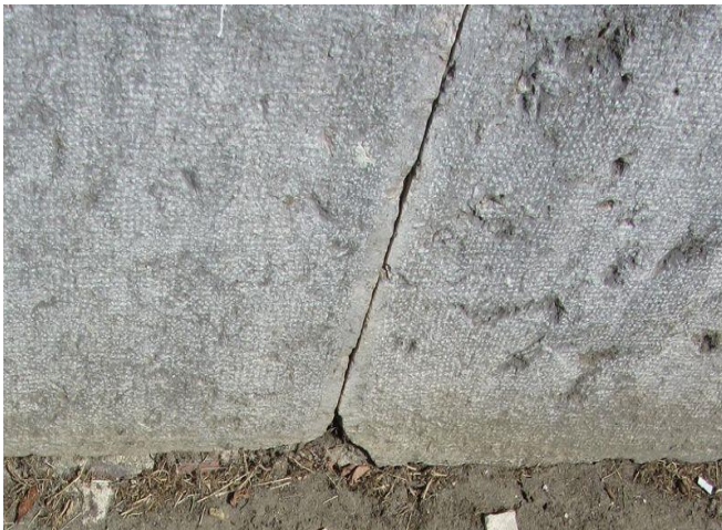
Figura 1- Ausência total de material de preenchimento de juntas, localizada na fachada lateral direita. Fonte: Autor, outubro 2017.
