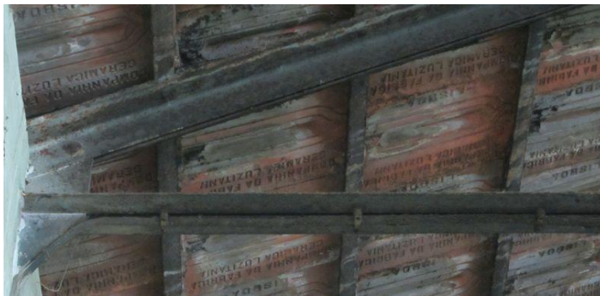
Figura 3- Pormenor da estrutura apresentando sinais de corrosão. Fonte: Autor, outubro 2017.
