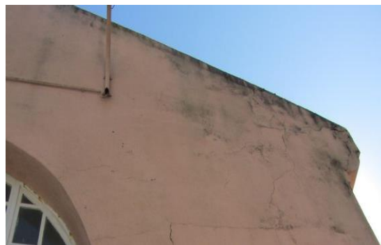
Figura 2- Mancha de humidade na parte superior da fachada principal. Fonte: Autor, outubro 2017.
