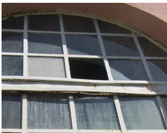
Figura 1- Perda de vidro no vão de janela situado na fachada lateral direita. Fonte: Autor, outubro 2017.
