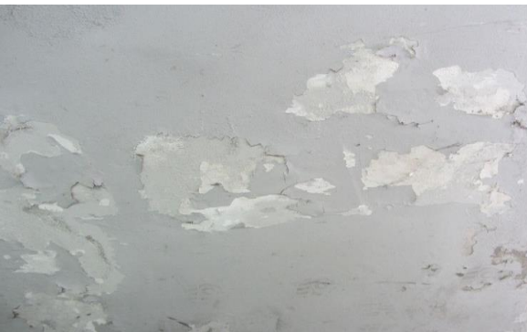
Figura 3- Destacamento de tinta, no paramento interior do lado direito. Fonte: Autor, outubro 2017.
