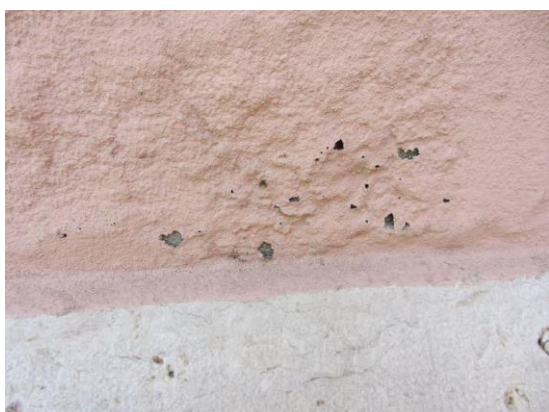
Figura 1- Empolamento dos materiais de revestimento devido a eflorescência/criptoflorescência. Fonte: Autor, outubro 2017.
