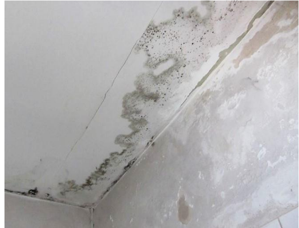
Figura 2- Humidades no teto da instalação sanitária, que também estão a afetar os paramentos adjacentes. Fonte: Autor, outubro 2017.
