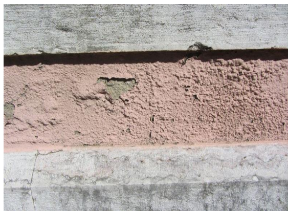
Figura 2- Empolamento e início de desagregação dos materiais de revestimento devido a eflorescência/criptoflorescência. Fonte: Autor, outubro 2017.
