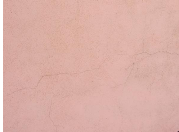
Figura 2- Fissuração na parede de fachada lateral direita. Fonte: Autor, outubro 2017.
