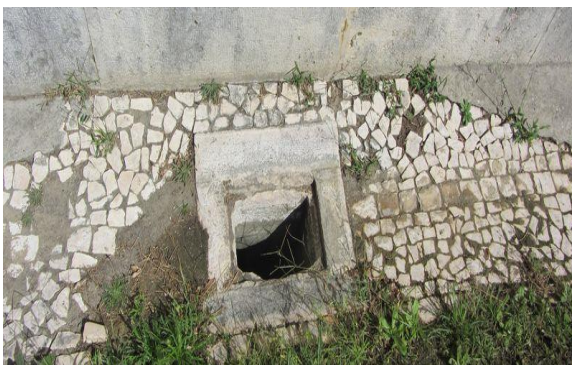
Figura 3- Presença de vegetação nos locais onde faltam elementos da calçada e entre juntas já degradadas, na fachada lateral direita. Fonte: Autor,
