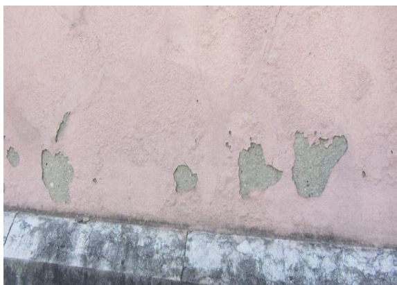
Figura 1- Destacamento de tinta. Fonte: Autor, outubro 2017.
