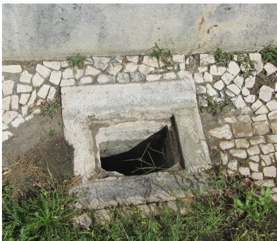
Figura 1- Caixa de visita sem grelha, situada na fachada lateral direita. Fonte: Autor, outubro 2017.
