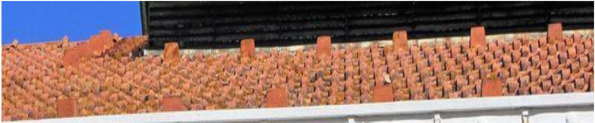
Figura 1- Vista exterior da cobertura, com as telhas manchadas de tom verde. Fonte: Autor, outubro 2017.
