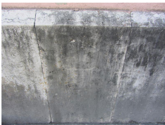
Figura 1- Crostas negras no soco da fachada principal. Fonte: Autor, outubro 2017.
