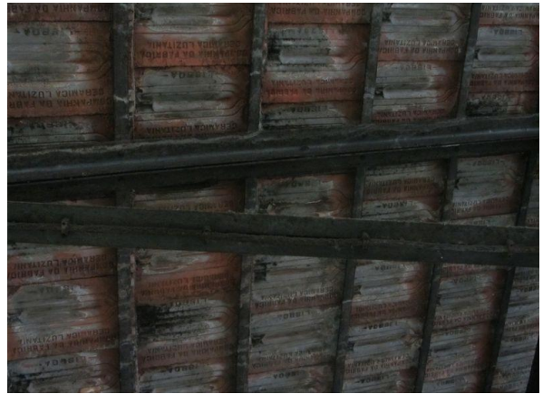
Figura 1- Pormenor de corrosão da estrutura. Fonte: Autor, outubro 2017.
