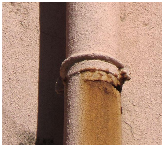
Figura 2- Pormenor da rotura do tubo de queda. Fonte: Autor, outubro 2017.
