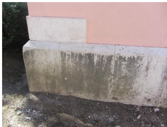
Figura 2- Crostas negras no soco da fachada lateral esquerda. Fonte: Autor, outubro 2017.
