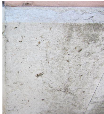
Figura 2- Alveolização presente na fachada lateral direita. Fonte: Autor, outubro 2017.
