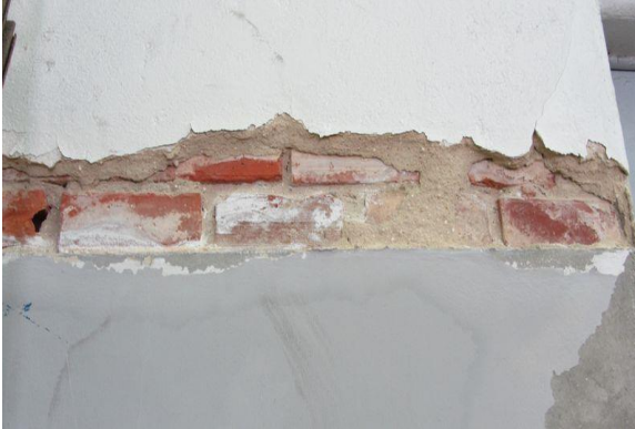
Figura 1- Destacamento do reboco, no paramento interior da arrecadação em frente da entrada. Fonte: Autor, outubro 2017.
