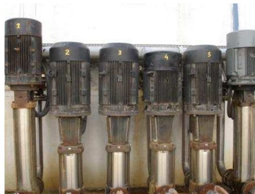
d – Central de Bombagem de água fria para moldes.
