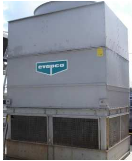
b – Torre de Arrefecimento.
