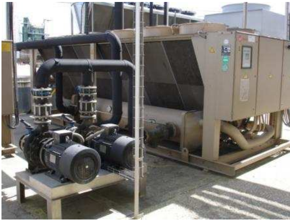
a – Refrigerador e bombas de circulação.
