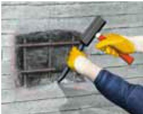
Figura 1 - Picagem do betão deteriorado
