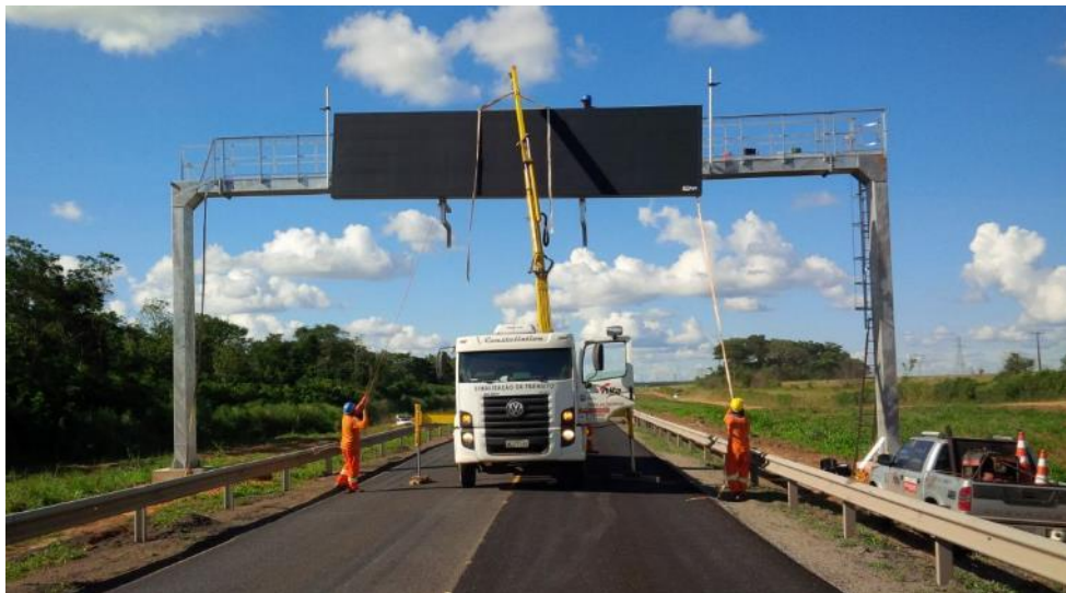
Figura 2.5 - Instalação de um painel de mensagem variável (Fonte: [8])
