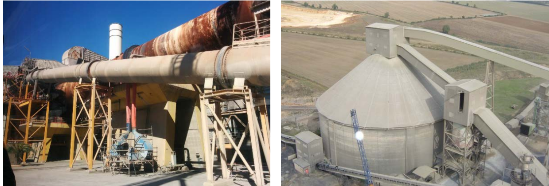
Figura 1.2 – Forno e Silo de Armazenagem de Clínquer (3)
