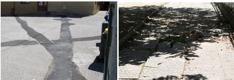
Figura 9: Estas fotografias foram tiradas, respetivamente, na escola A e H e ilustram irregularidades no piso.
