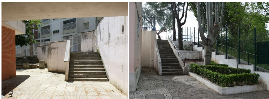
Figura 10: Nas fotografias podemos observar escadas de acesso aos diferentes patamares do espaço recreio e que oferecem alguma perigosidade. A fotografia da esquerda foi tirada na escola H e a da direita na L.
