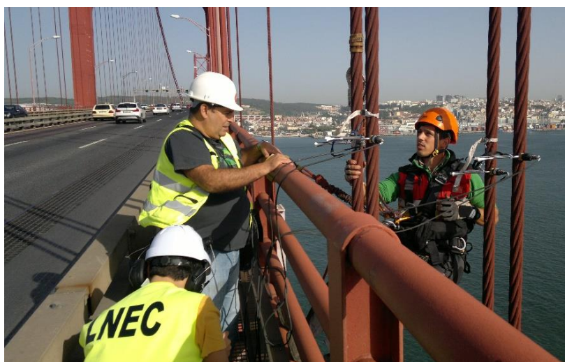
Figura 5.59 - Execução do ensaio realizado a um dos conjuntos de pendurais da ponte.
