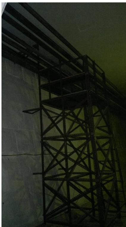
Figura 5.9 - Torre de acesso ao sistema hidrostático.
