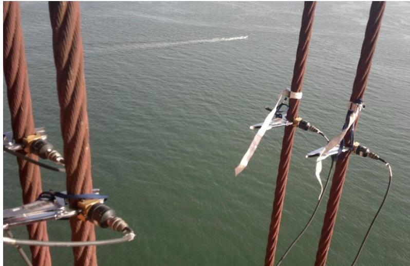
Figura 5.52 - Acelerómetros instalados nos pendurais da ponte.
