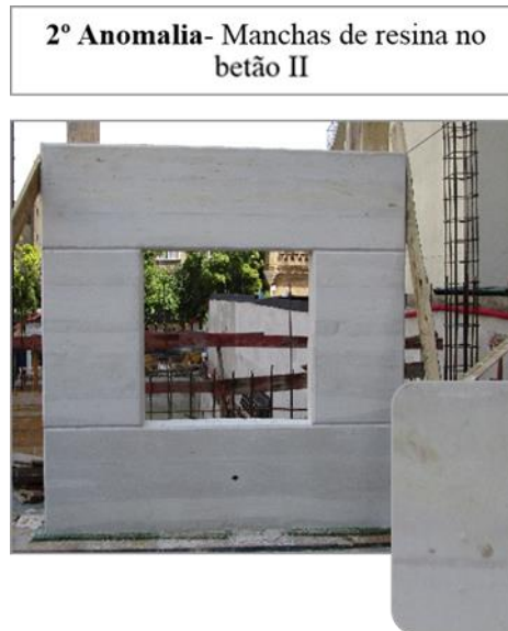
Figura 4.21: Pormenor da anomalia manchas de resina no betão - Protótipo nº 3, 2015.
