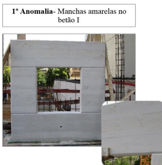
Figura 4.20: Pormenor da anomalia manchas amarelas no betão – Protótipo nº 3, 2015.
