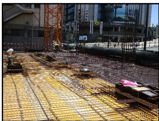
Figura 3.17: Aplicação da armadura e cofragem da pala localizada na laje do piso 1, 2015.
