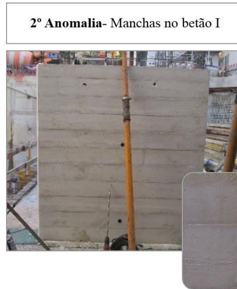
Figura 4.12: Pormenor da anomalia gerada por manchas no betão - Protótipo nº 1, 2015.
