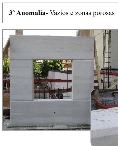
Figura 4.22: Pormenor da anomalia de vazios e zonas porosas - Protótipo nº 3, 2015.
