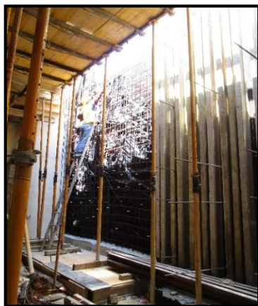
Figura 3.15: Trabalhos de armadura e cofragem realizados no terceiro troço da parede Pa2f, 2015.
