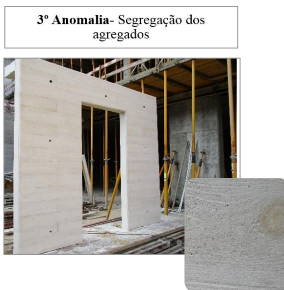
Figura 4.17: Pormenor da anomalia de segregação dos agregados – Protótipo nº 2, 2015.
