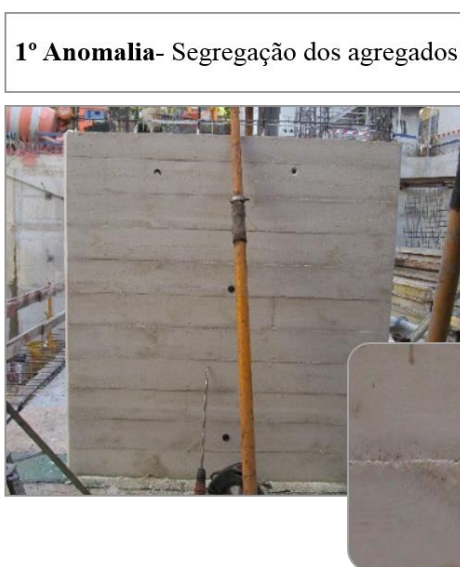
Figura 4.11: Pormenor da anomalia segregação dos agregados – Protótipo nº 1, 2015.
