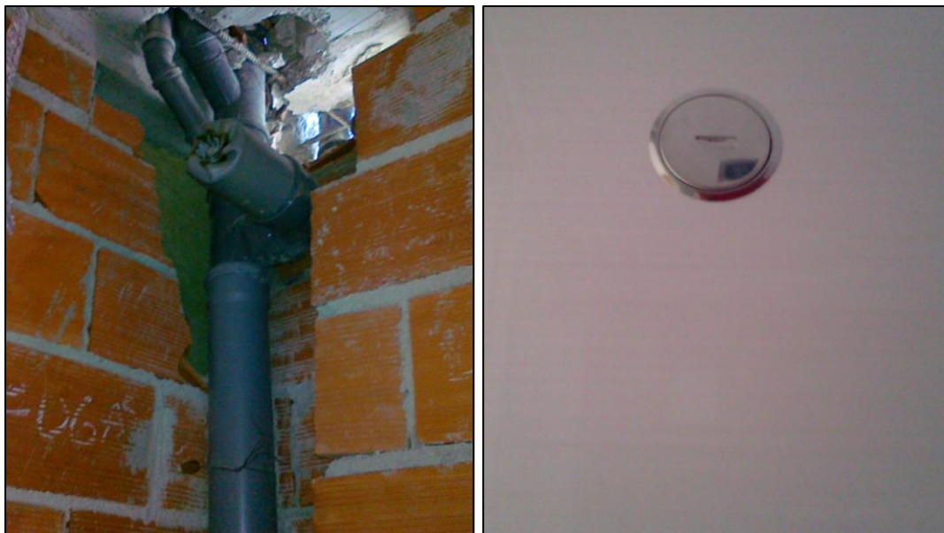
Figura 4.12 - Tubo de queda com boca de limpeza
