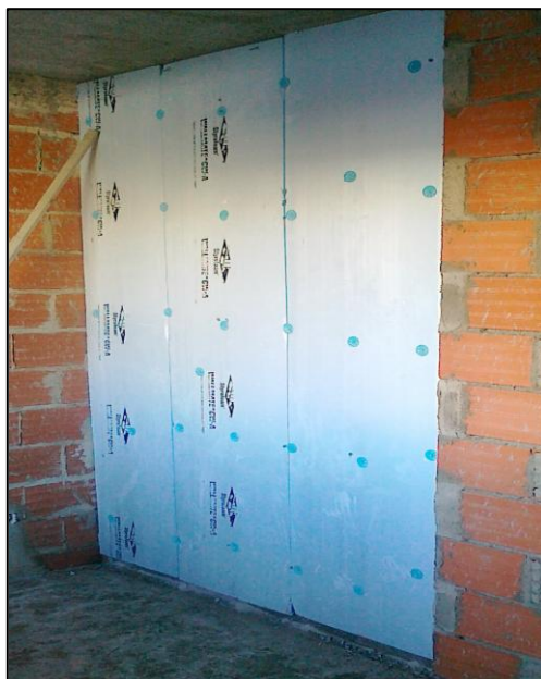
Figura 3.21 – Isolamento de poliestireno extrudido - caixa de elevador
