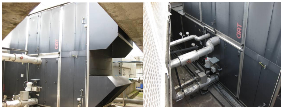
Figura 5.7 – UTA de dois andares (à esquerda) e tubagem de ida e retorno das baterias (à direita).
