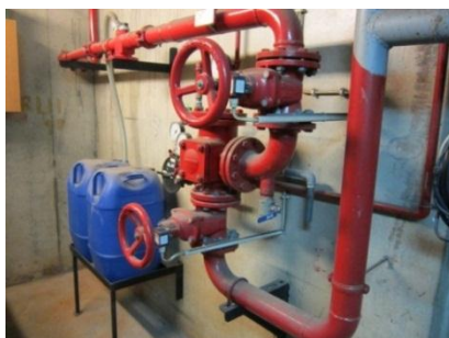
Figura 5.11 – Sistema de injeção de espumífero do depósito de combustível.
