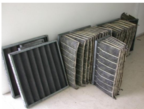
Figura 5.8 – Pré-filtros (do lado esquerdo) e filtros de sacos (do lado direito).
