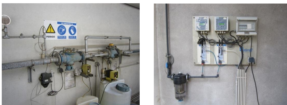
Figura 5.4 – Sistema de doseamento de cloro, biocida e inibidor de corrosão (à esquerda) e sistema de análise e controlo de cloro e sistema de purga automático (à direita).
