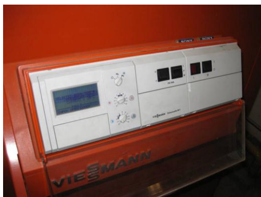
Figura 5.6 – Painel de controlo e automação das caldeiras.
