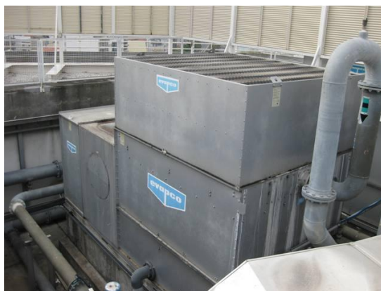
Figura 5.3 – Torre de arrefecimento de circuito aberto com insuflação forçada de ar.
