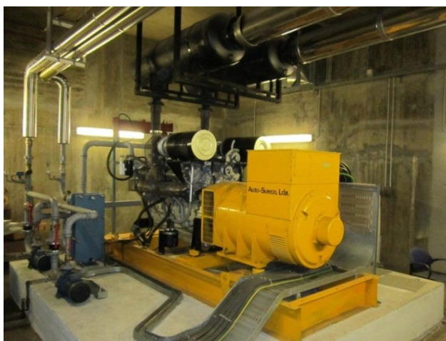
Figura 5.9 – Gerador de emergência da Volvo de 800 kVA (Diesel).
