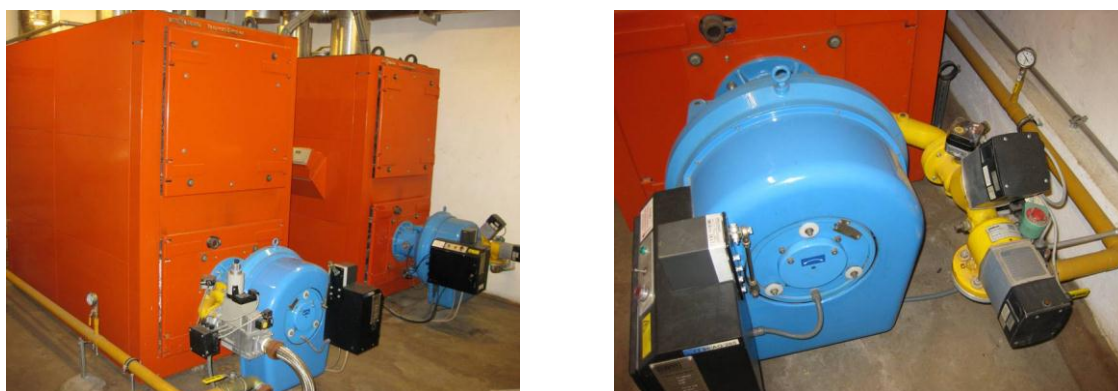
Figura 5.5 – Caldeiras do edifício Atrium Saldanha da VISSMANN.
