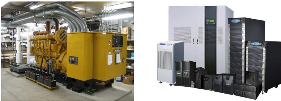
Figura 4.26 – Grupo gerador diesel CAT de 1875 kVA (à esquerda) e diferentes tipos de UPS (à direita) (52) (53).
