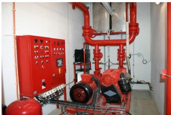
Figura 4.32 – Central de bombagem de um sistema de extinção de incêndios (58).
