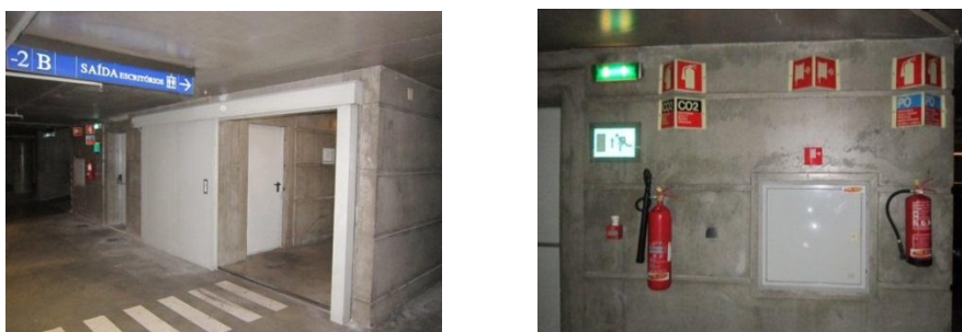
Figura 5.10 – Porta corta-fogo (à esquerda). Extintores e carretel (à direita).
