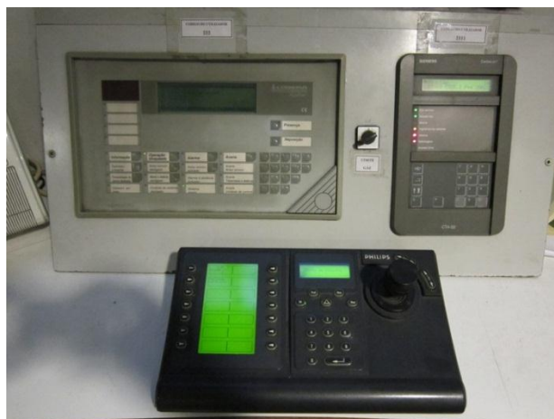
Figura 5.12 – Central de incêndio (Central de Segurança).
