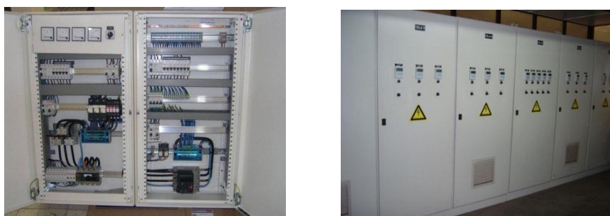
Figura 4.24 – Quadros eléctricos utilizados em edifícios (42) (43).
