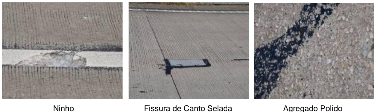
Figura 5.2 - Patologias Identificadas no Pavimento nas Inspeções Visuais [17]
