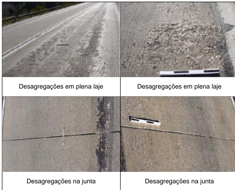
Figura 4.27 - Exemplo de desagregações superficiais [16]
