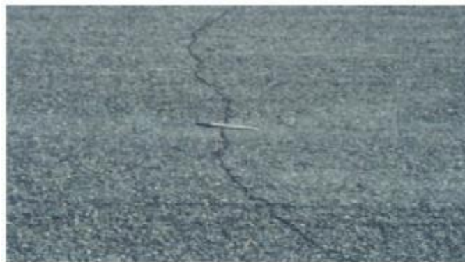
Figura 4.16 - Exemplo de fendas longitudinais/transversais [12]
