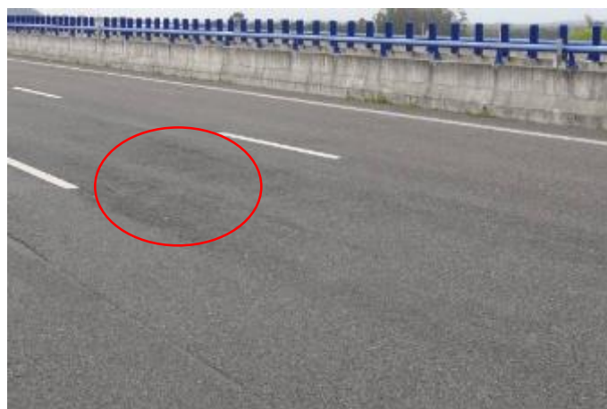
Figura 4.18 - Exemplo de desagregação superficial [11]
