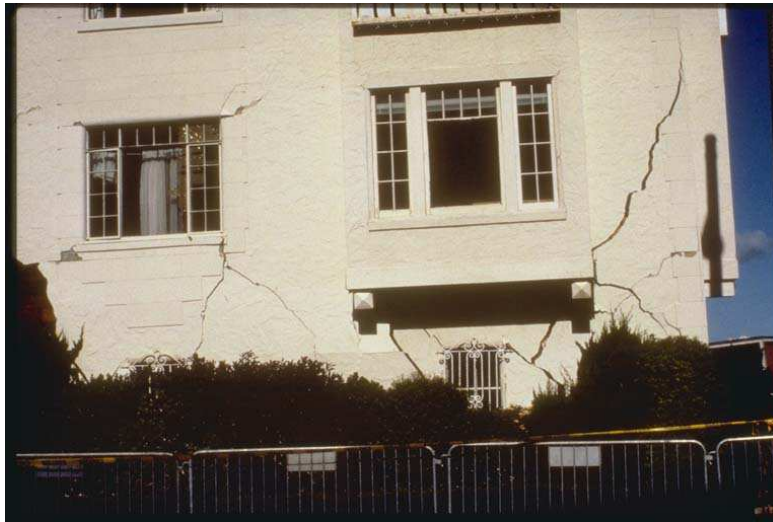
Figura 2.3: Fissuração motivada por sismo
