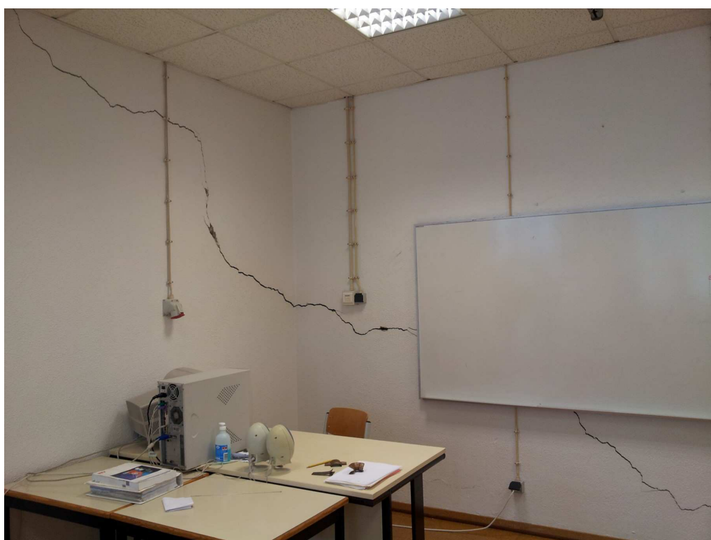
Figura 4.2: Fissuração por assentamento de fundações
