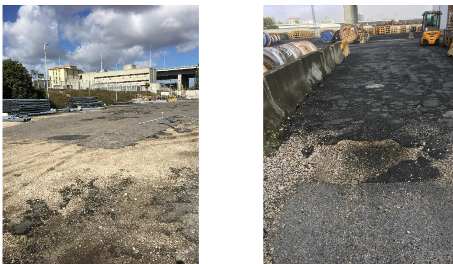
Figura 3.9 - Degradação do Pavimento da AAE do Armazém Central de Sacavém
