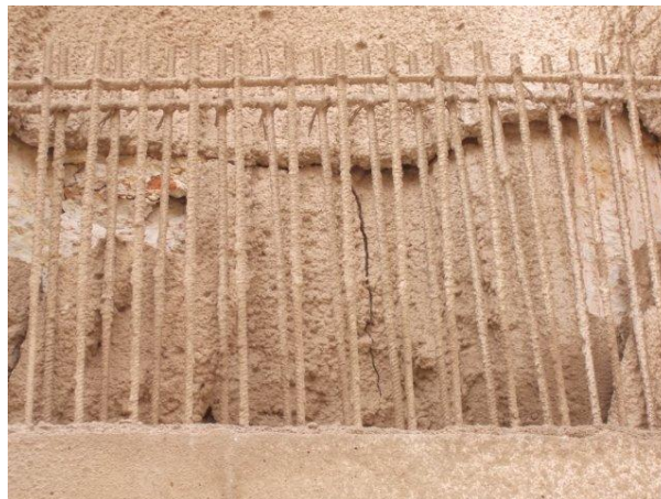
Figura 3.4 - Viga de coroamento com armadura de espera para a estrutura (cortesia Geofix)
