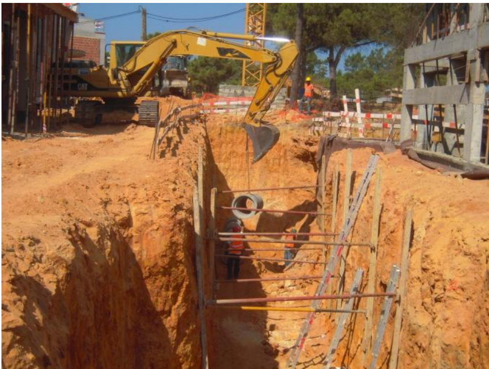
Fotografia 3 – Vala com sistema de entivação insuficiente
