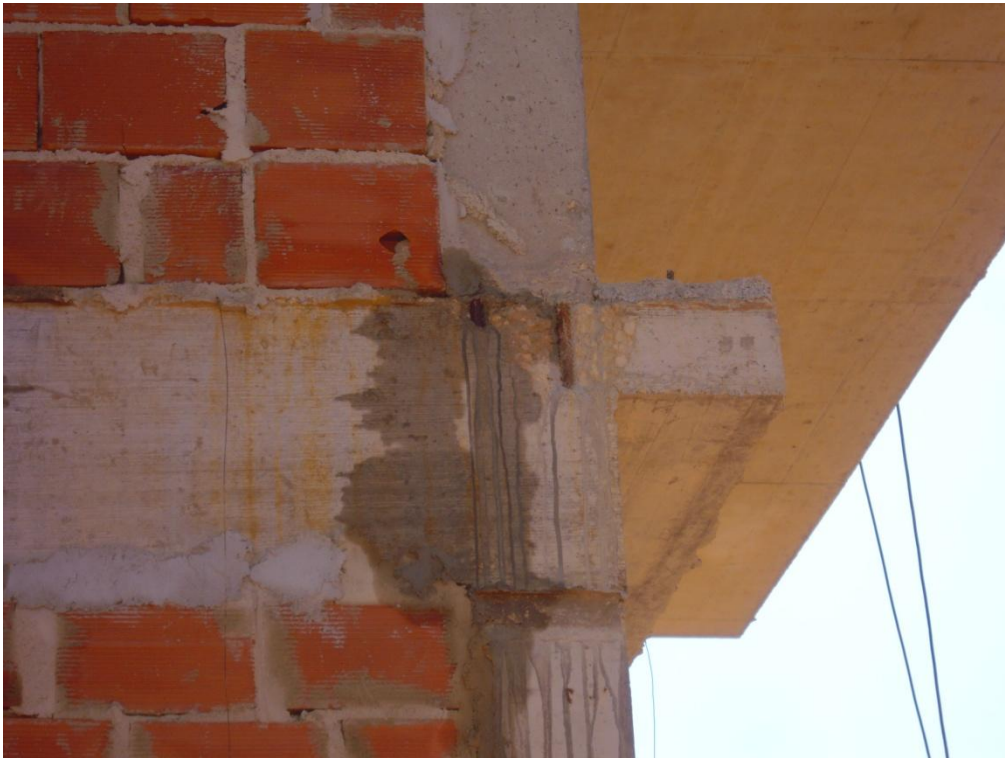
Fotografia 10 – Viga de bordadura com recobrimento insuficiente
