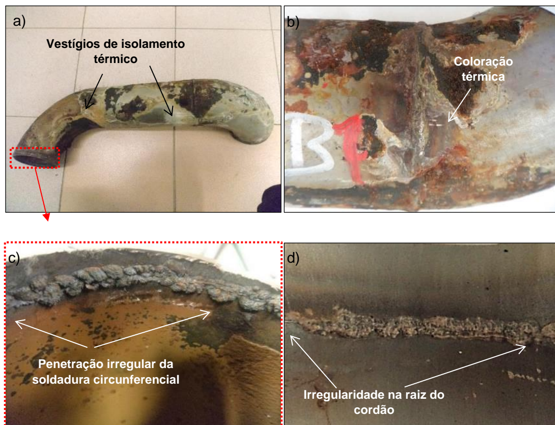
Figura 4.8 – Amostra B onde se observam: a) resíduos do isolamento térmico; b) zona com coloração térmica junto da soldadura; c) e d) detalhe da amostra B revelando defeitos na soldadura circunferencial.
