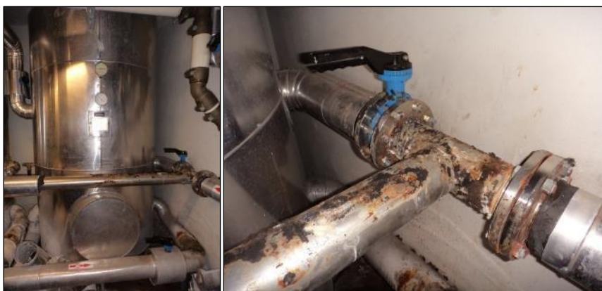
Figura 4.1 - Evidência de oxidação das tubagens em aço inoxidável com resíduos do isolante polimérico fortemente aderente ao tubo: a) Geral; b) Pormenor da zona com ligações flangeadas e presença de óxidos na superfície do tubo.
