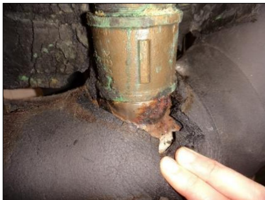
Figura 4.5 - Zona com união roscada onde se observam evidências de escoamento de produtos esverdeados típicos indicativos da presença de cobre.
