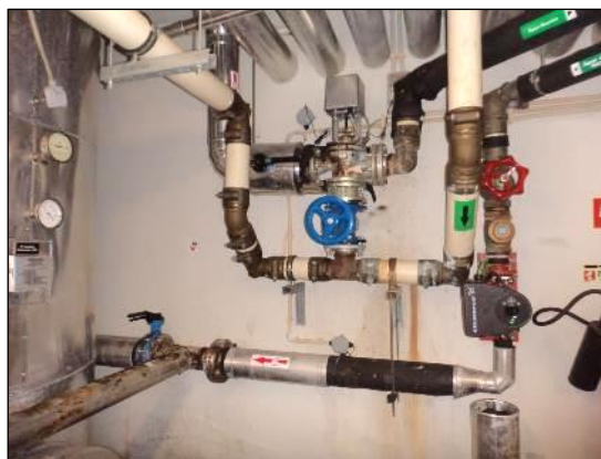
Figura 4.4 - Vista geral de uma zona do circuito de AQS onde se podem observar locais com evidências de escorrimento esverdeado, comum em produtos de corrosão com cobre, próximo de acessórios de ligação
