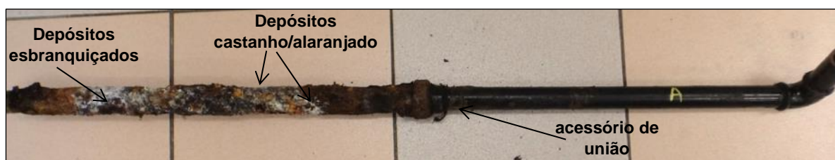
Figura 4.7 – Amostra A onde se observa que um dos troços se encontra fortemente degradado;
