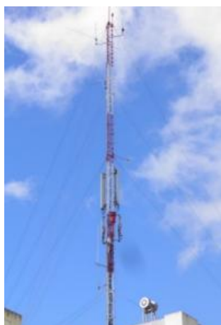
a) Torre espiada em edifício
