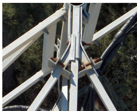
Figura 5.24 – Parafusaria dos interfaces com corrosão
