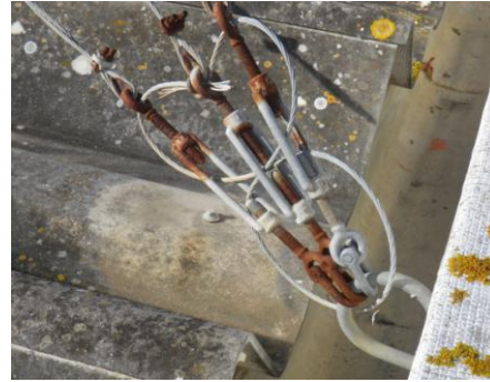
b) Esticadores e cerra-cabos com corrosão
