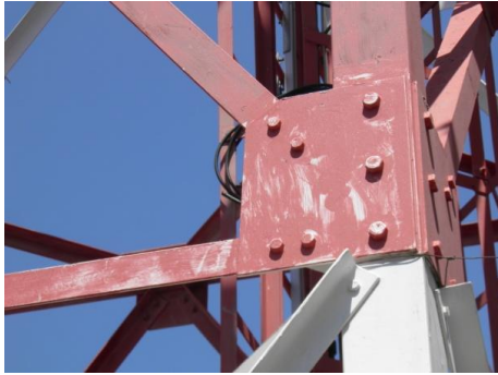
Figura 3.15 – Vestígios de desgaste e perda de tonalidade numa torre metálica
