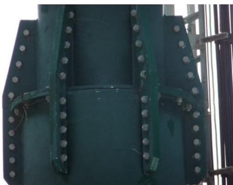
Figura 2.4 – União entre troços por flange aparafusada
