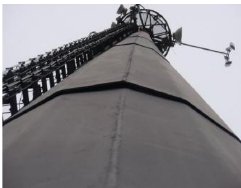
Figura 5.10 – Vista geral do fuste onde é visível um espaçamento excessivo entre troços
