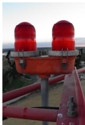
Figura 2.36 – Exemplo de sinalizador luminoso
