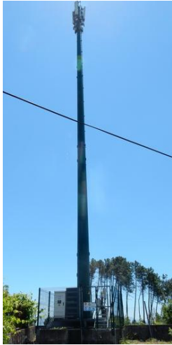
Figura 2.7 – Torre tipo Light
