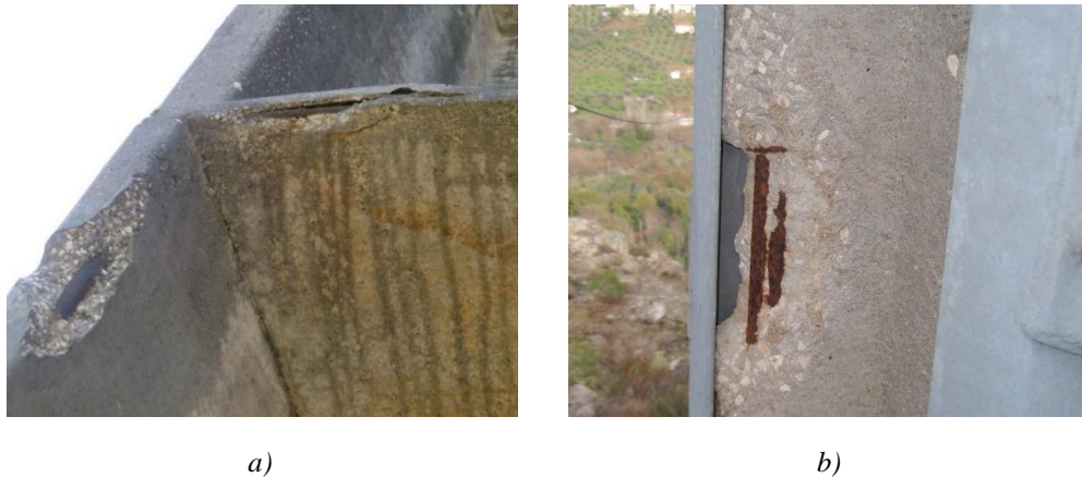
Figura 3.21 – Exemplos de desagregação do betão e exposição de armaduras
