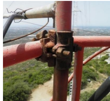
c) Abraçadeira com corrosão acentuada
