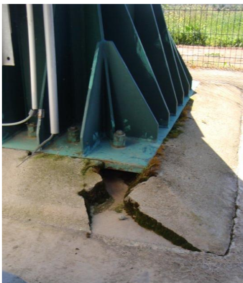
Figura 4.12 – Anomalia em maciço de encabeçamento
