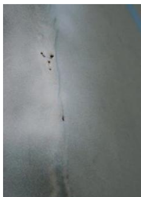
Figura 3.13 – Cordão de soldadura com poros
