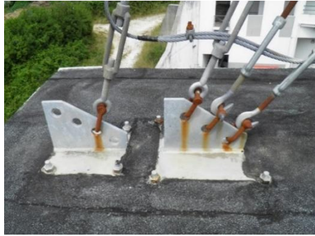
a) Manilhas com corrosão
