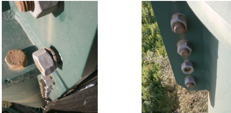
a) Vista da folga entre chapa e sistema de aperto b) Vista da rosca da porca desapertada
