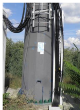
Figura 5.4 – Falta de troço de escada inicial e porta anti escalamento
