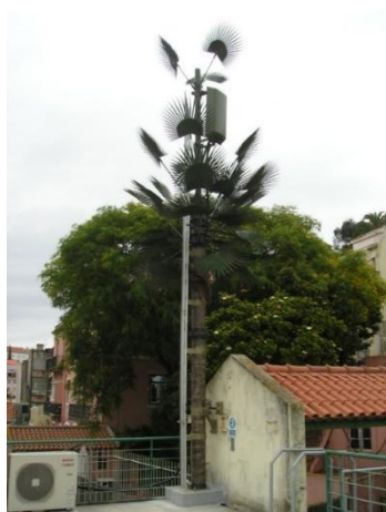
a) Exemplo de torre árvore
