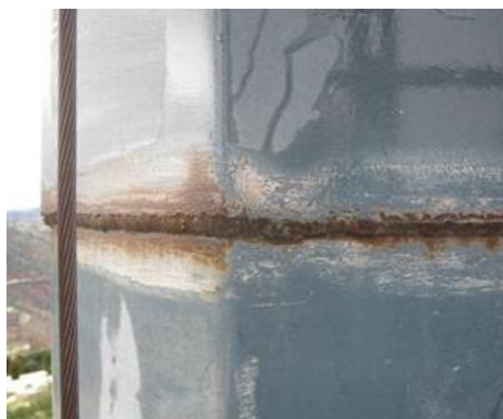
Figura 3.14 – Cordão de soldadura corroído por falta de proteção anti corrosiva
