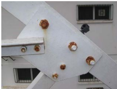
Figura 3.6 – Ligação aparafusada entre perfis com corrosão
