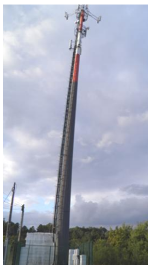
Figura 5.2 – Desvio verticalidade da torre Canas de Senhorim
