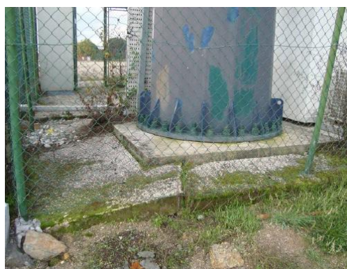
Figura 5.3 – Anomalias na pintura da torre e fissuração grave na laje
