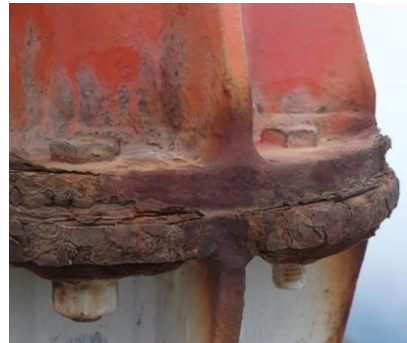
Figura 3.7 – Ligação aparafusada entre montantes com corrosão
