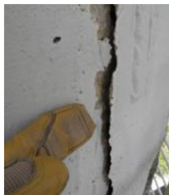
Figura 3.20 – Fissura na estrutura de betão armado
