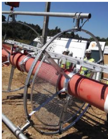
Figura 5.16 – Pormenor das plataformas e interfaces instalados na nova torre
