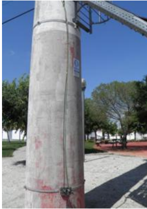
Figura 3.22 – Perda de tonalidade do fuste de betão armado
