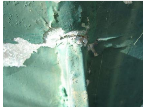
Figura 3.12 – Cordão de soldadura de um gousset da base a abrir
