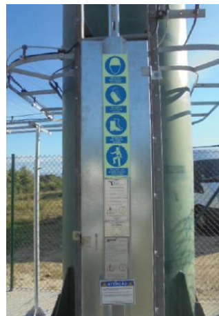
Figura 5.17 – Pormenor da porta anti-escalamento e sistema anti-queda instalados
