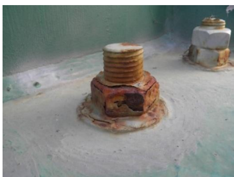
Figura 3.28 – Perno com corrosão e falta de contraporca
