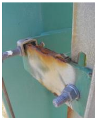
Figura 3.25 – Ligação escada/torre com corrosão avançada
