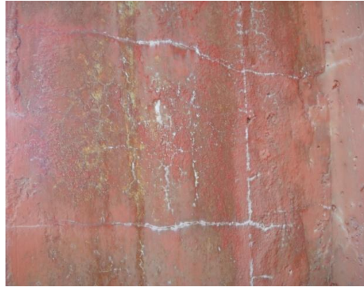
Figura 3.23 – Desgaste de pintura em torre de betão armado
