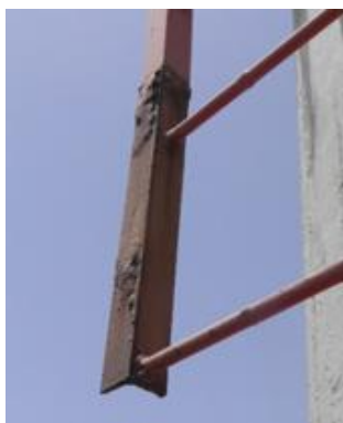
Figura 3.24 – Troço de escada com corrosão
