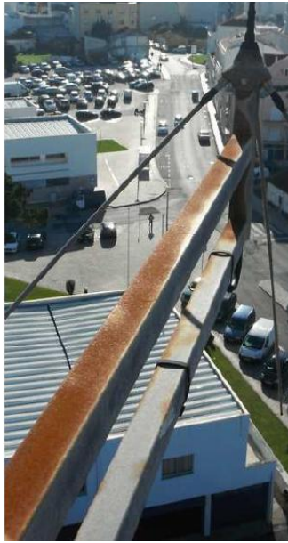
a) Interface com presença de corrosão
