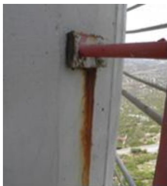
Figura 3.19 – Escorrência de corrosão na estrutura de betão
