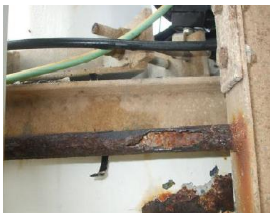
Figura 4.8 – Degrau de escada com perda de secção devido a corrosão
