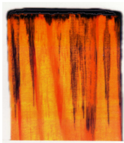
Figura 51 - Manchas causadas por fungos no topo de uma peça de madeira [65]
