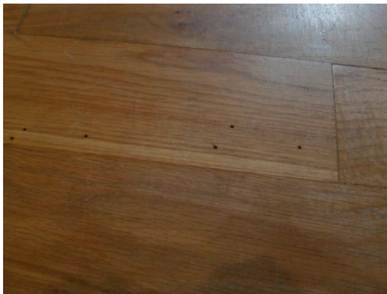
Figura 53 - Furos de saída do caruncho num revestimento de piso em madeira
