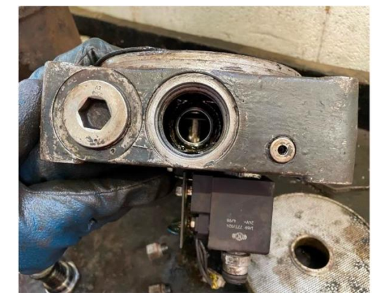
Figura 6.20 - Sede da válvula de descarga.
