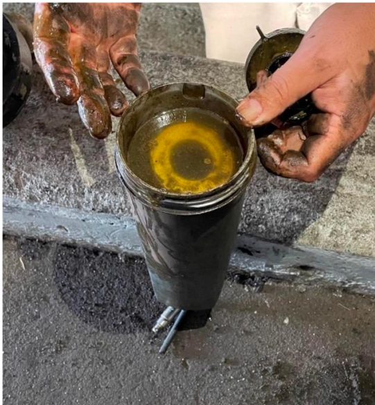
Figura 6.15 - Filtro de óleo (A20) colmatado com água devido à não atuação da torre de secagem.
