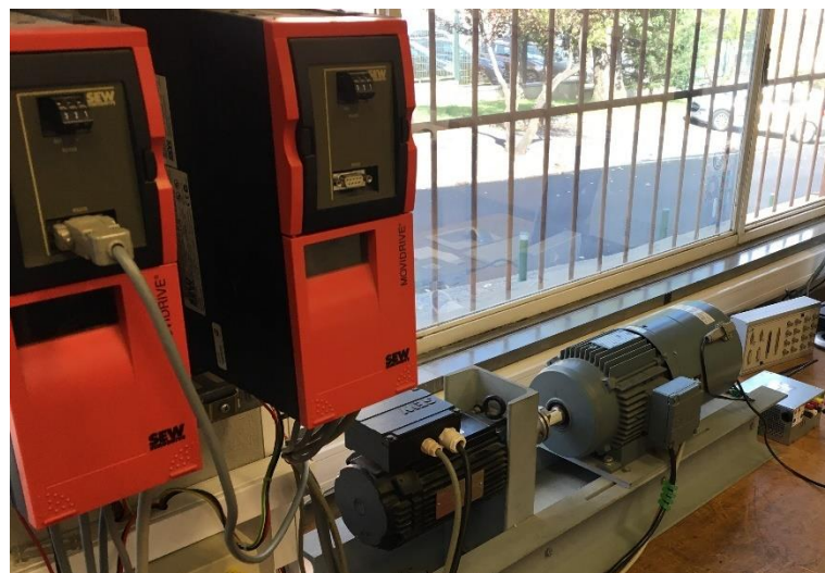
Figura 5.50 – Variador de velocidade e acoplamento do motor assíncrono com o gerador síncrono de magnetos permanentes.
